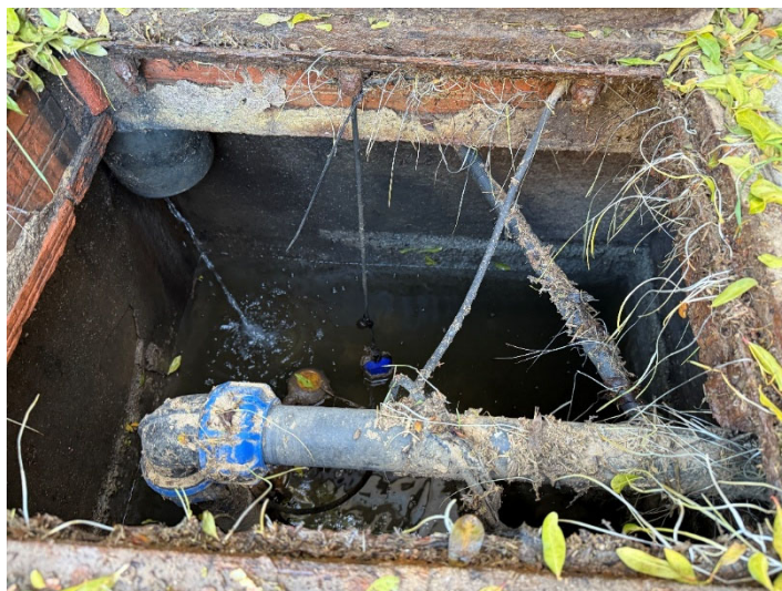
Figura 6. Arqueta del bombament existent a anul·lar.
