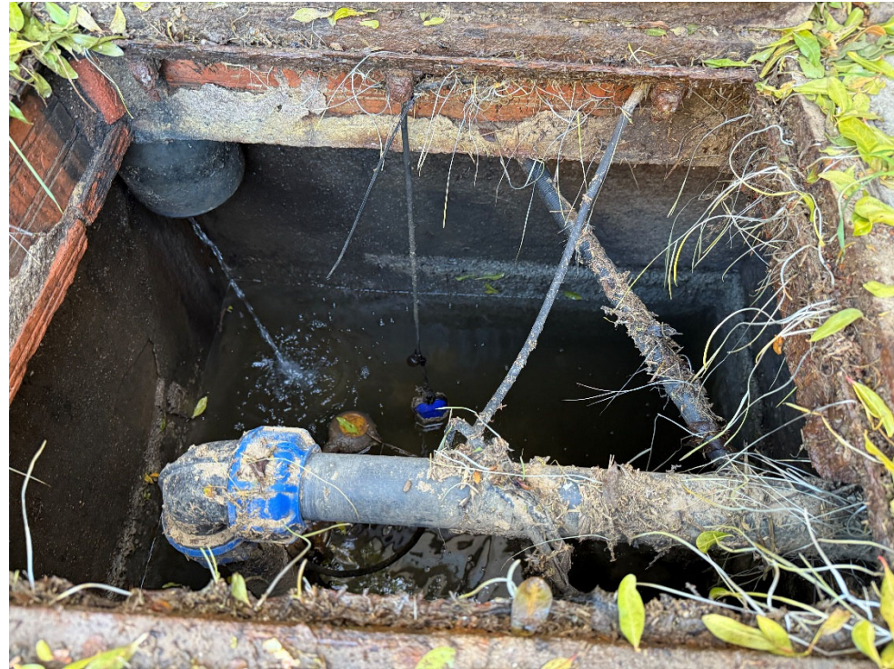
Figura 3. Arqueta del bombament existent a anul·lar.
