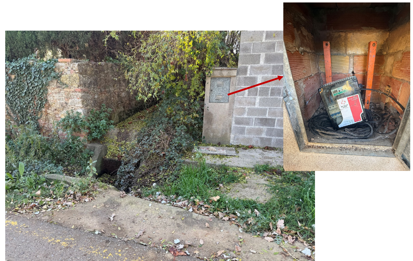
Figura 2. Bombament existent al C/ Major i instal·lació de maniobra
