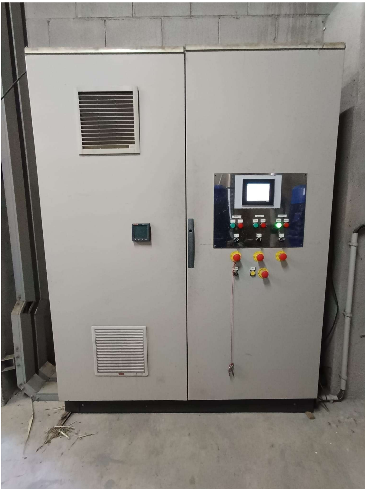
Vista exterior armari elèctric
