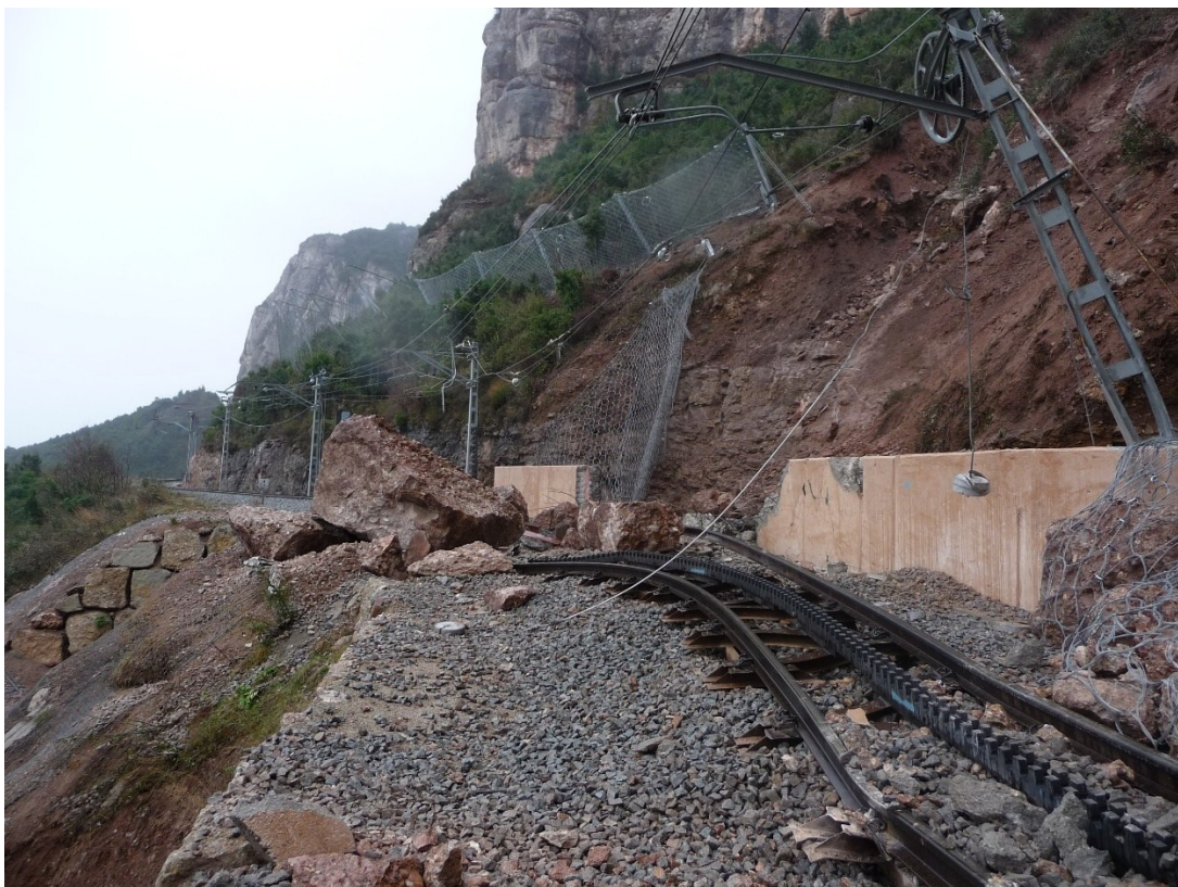
Figura 5. Desprendiment en roca dura (muntanya de Montserrat, desprendiments en conglomerats).
