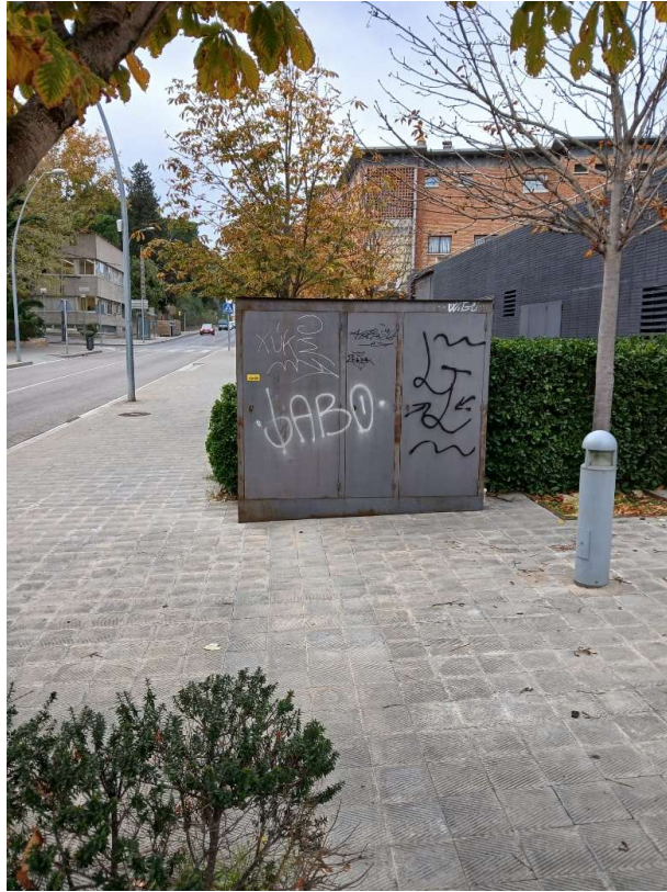
Imatge 2. Quadre d'enllumenat públic 188
