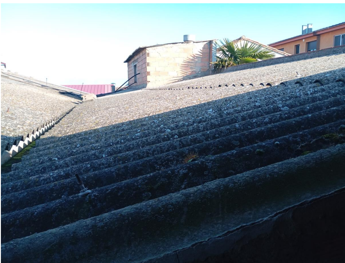
Estat coberta actual fibrociment.
