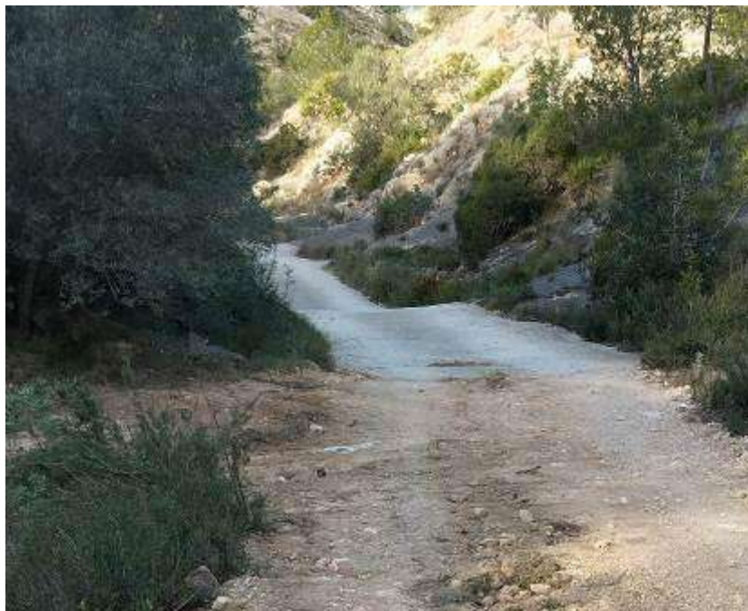
Pas de barranc de formigó malmès
