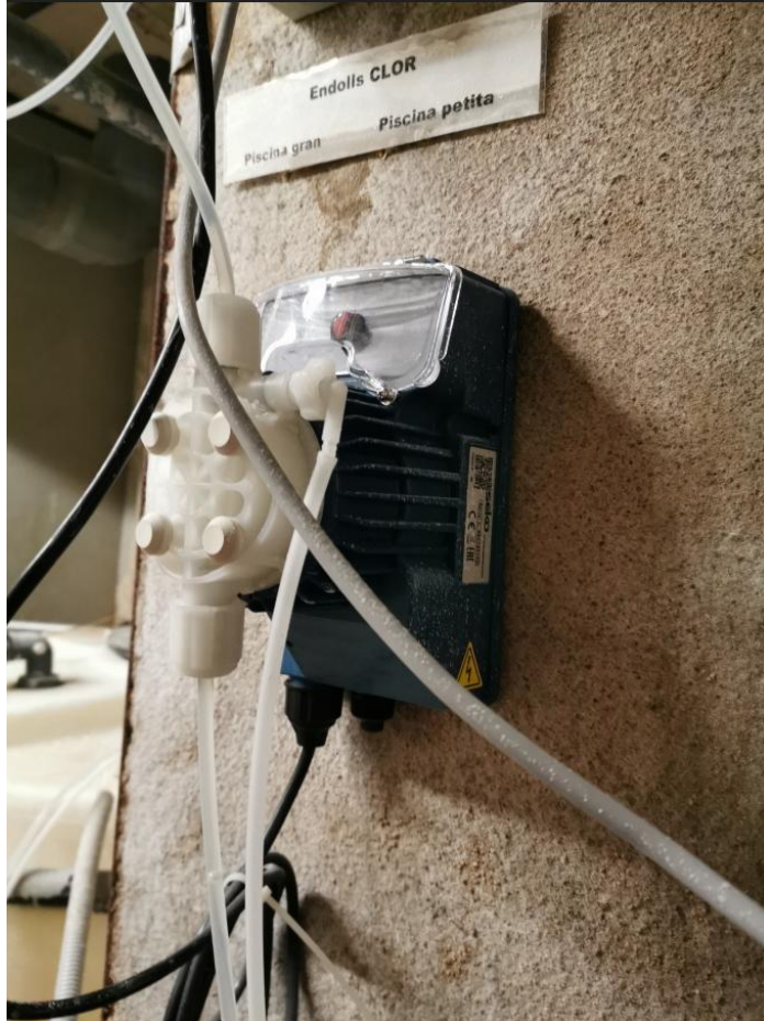
Bomba de clor i PH (2unitats)
