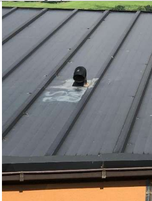
Filtracions d'aigua per conductes de ventilació.
