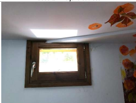
Humitat de filtració de la coberta vora la finestra.
