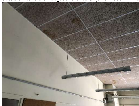
Sostre menjador. Plaques en mal estat per filtracions de la coberta.
