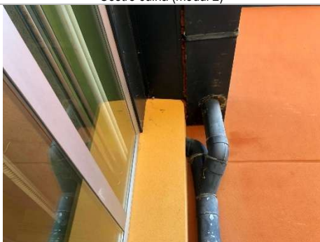
Embocadura de baixant amb canaló. Manca d'estanqueïtat
