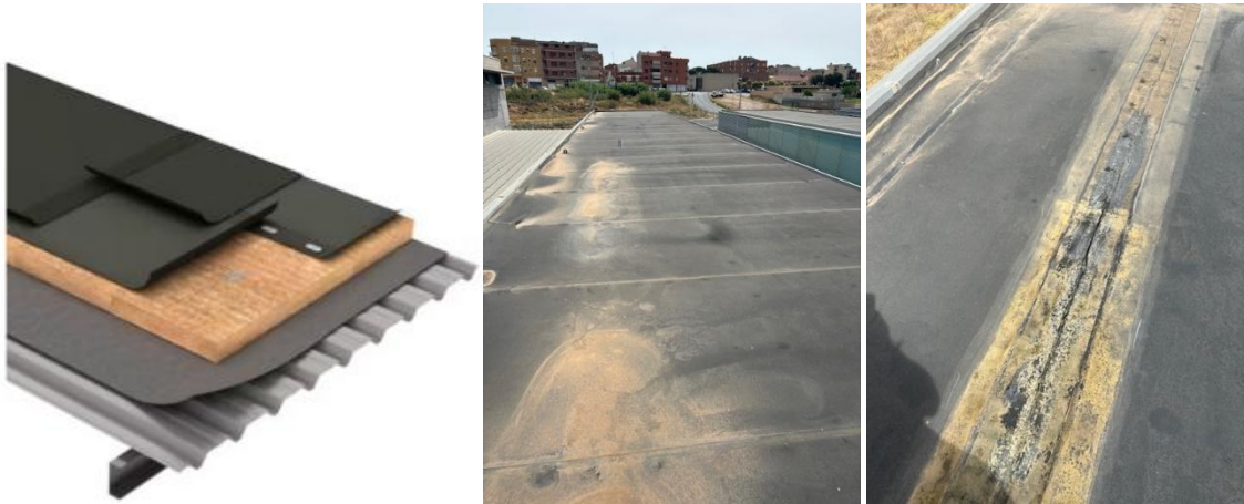
Detall solució actual de coberta i imatges de les filtracions
