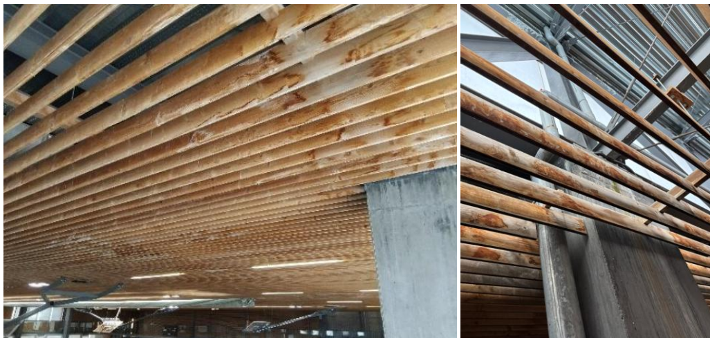
Imatges dels paraments interiors malmesos
