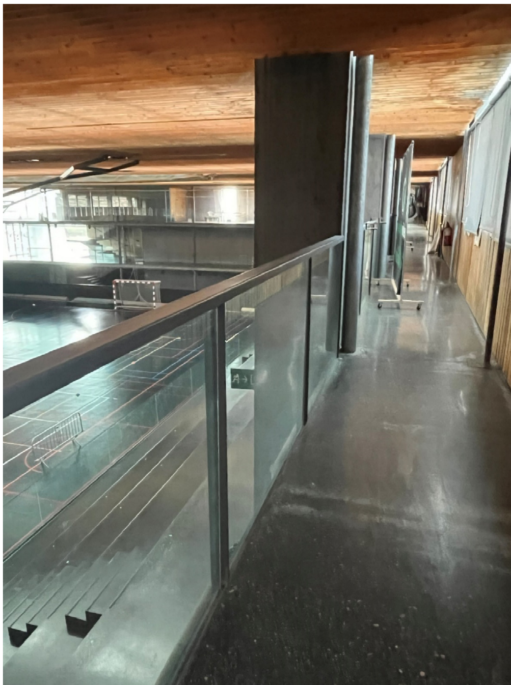
Figura 19: Decoloracions i taques d'eflorescències en els paviments
