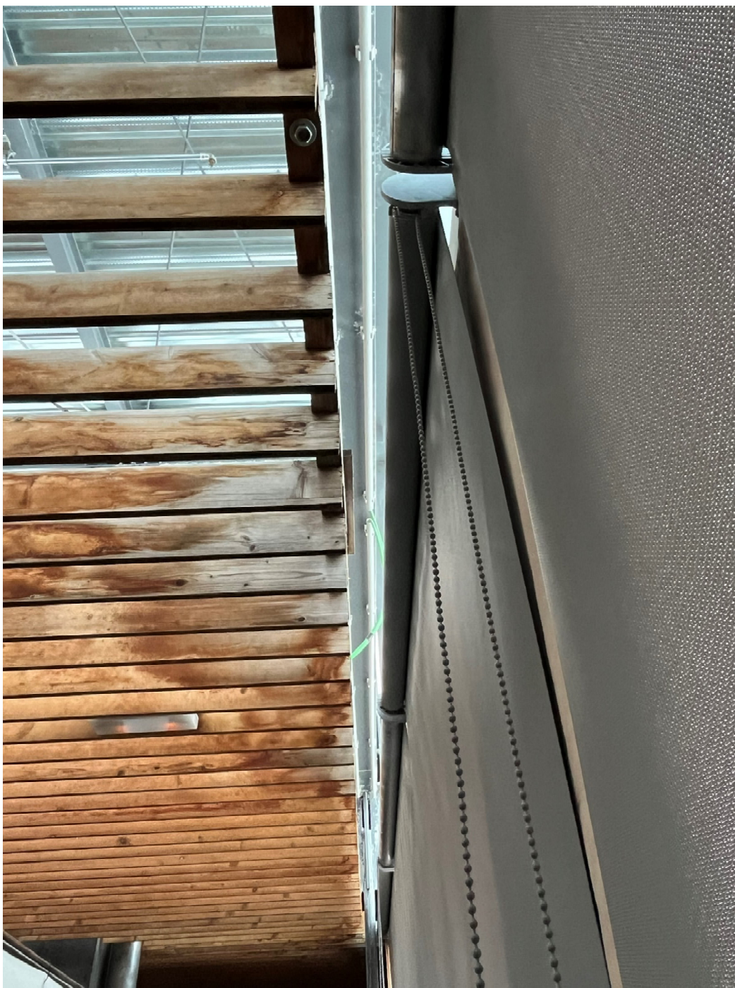
Figura 17: Decoloració de la fusta del pla de fals sostre del pavelló
