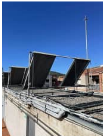
PC.1 Falta de manteniment
