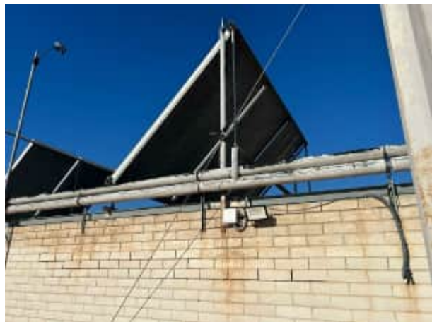
PC.2 Mal estat aïllament conductes
