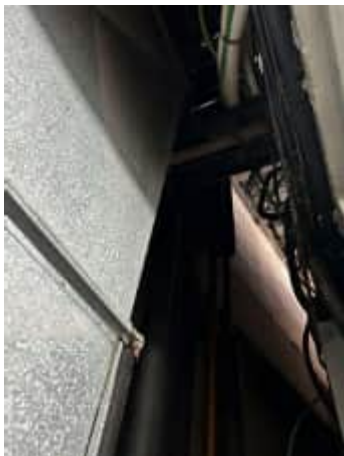
P1.2 Coberta de protecció d'aigua ineficient (es muja el pati)
