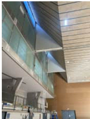
P2.1 Estat actual condensacions i filtracions
