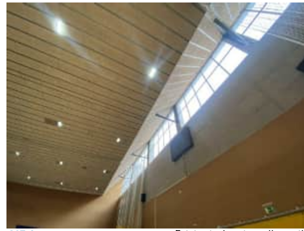
SOT.3 Estat actual sostre poliesportiu
