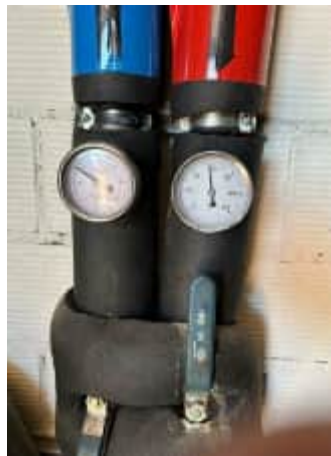
P3.12 Termomètre ACS solar no funciona
