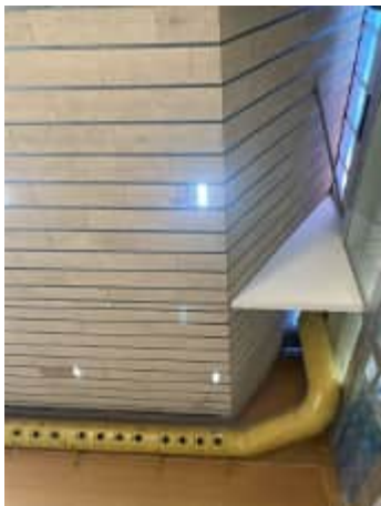
P2.2 Estat actual sostre amb filtracions
