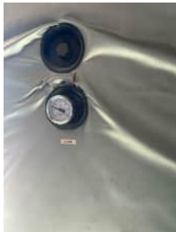
P3.11 Termomètre ACS solar no funciona
