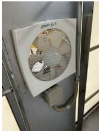
P1.1 Sistema extracció deficient a tots els vestidors de totes les plantes
