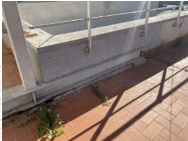
P3.4 Creixement de vegetacions per falta de manteniment
