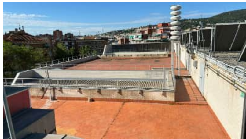
P3.2 Estat actual coberta. Creixement de vegetació en juntes
