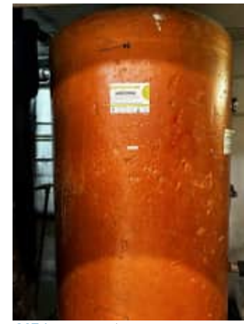
SOT.4 Dipòsit ACS fora de servei
