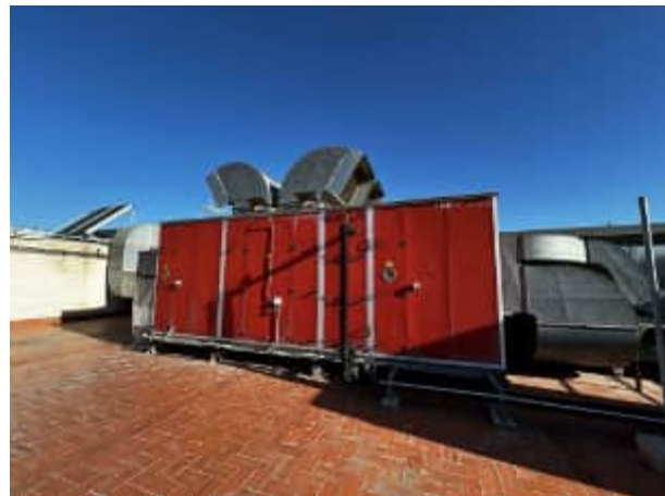
P3.13 UTA existent. (Antiga, mal funcionament i sense recuperació d'energia)
