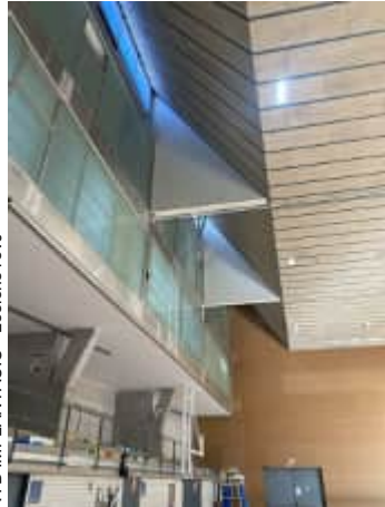
SOT.5 Estat actual condensacions i filtracions
