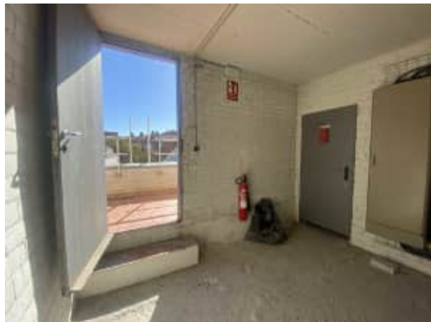
P3.1 Desnivell en sala d'instal·lacions respecte la cota de coberta
