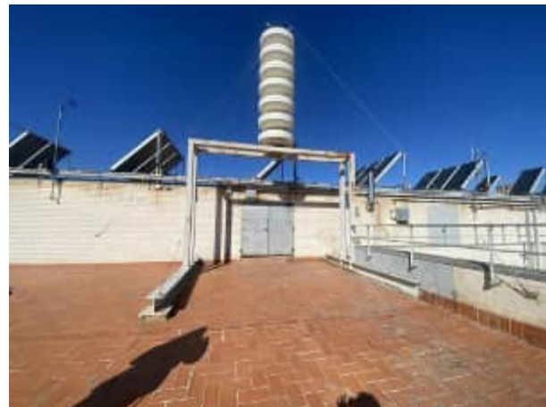
P3.14 Sirena protecció civil existent a desplaçar
