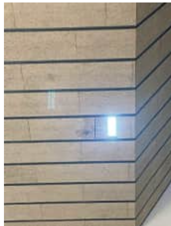
P2.2 Estat actual sostre amb filtracions
