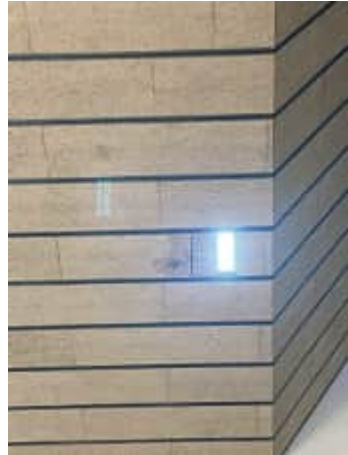
SOT.6 Estat actual sostre amb filtracions
