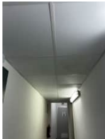
P1.3 Cel ras actual col·lapsat (previsió de nous sistemes en actuació)
