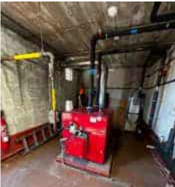
Foto 12 (05/03/2024): Caldera de gas Roca
