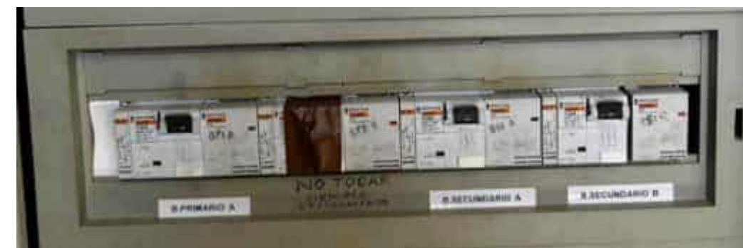
Figura 19. Bomba primari ACS solar desconnectada.
