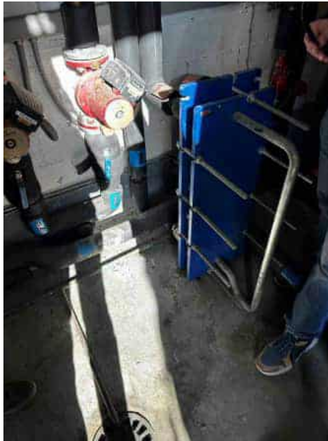
Foto 4. Bescanviador primari ACS solar sense aïllar tèrmicament.
