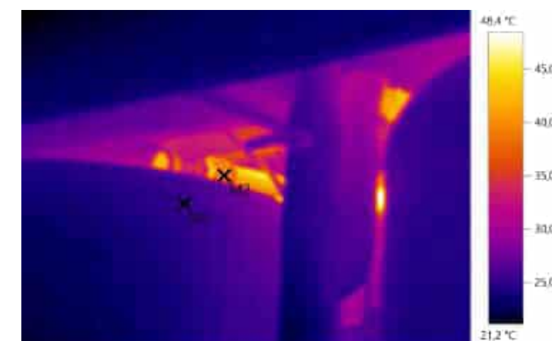
Foto 3: Termografia sala d'acumulació ACS planta baixa
