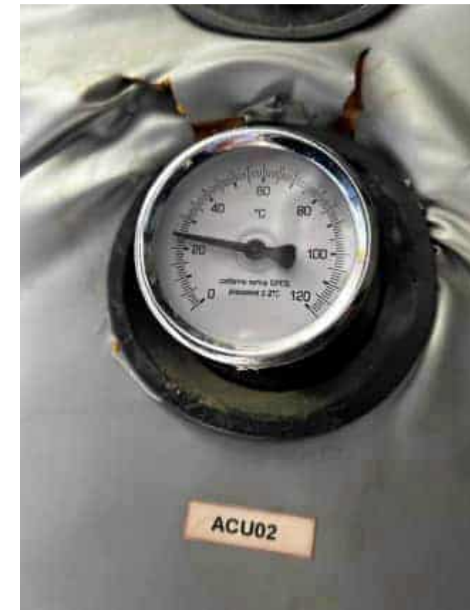
Foto 6. Temperatura acumulador ACS solar en el moment de la visita realitzada.
