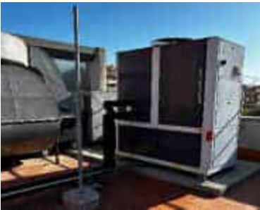
Foto 11: Bomba de calor aire-aigua
