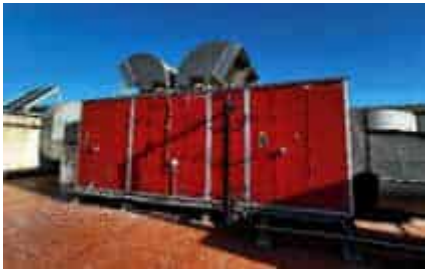
Foto 10 (05/03/2024): Unitat de tractament d'aire existent a la coberta de l'Olivera
