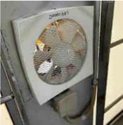
Foto 14: Ventilador d'extracció a un dels vestuaris del poliesportiu
