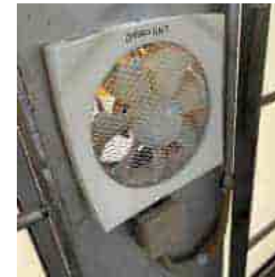
Foto 7: Ventilador d'extracció a un dels vestuaris del poliesportiu
