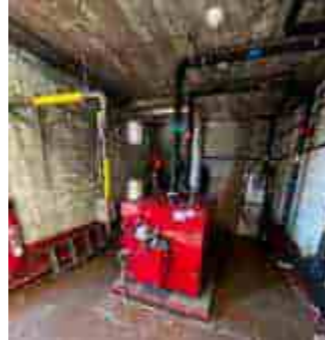
Foto 3 (05/03/2024): Caldera de gas Roca
