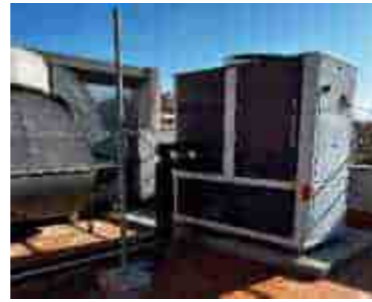
Foto 2: Bomba de calor aire-aigua
