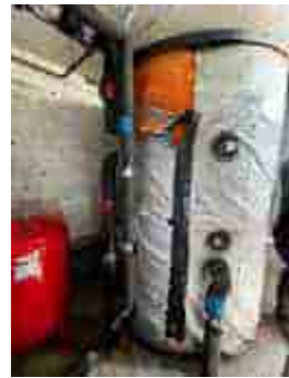
Foto 5 (05/03/2025) Dipòsit d'acumulació dels panells solars tèrmics
