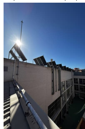
Foto 11. Instal·lació plaques ACS solar a desmuntar
