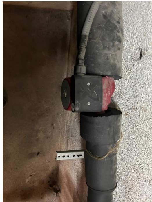
foto 7. Bomba recirculadora ACS
