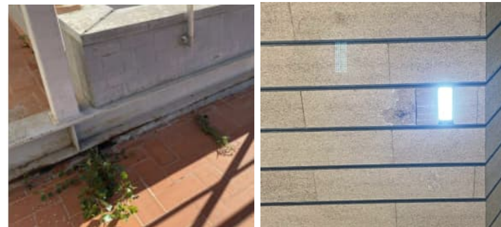
Figura 4: Creixement de vegetació en planta Figura 3: Filtracions en cel ras coberta, per falta de manteniment.
