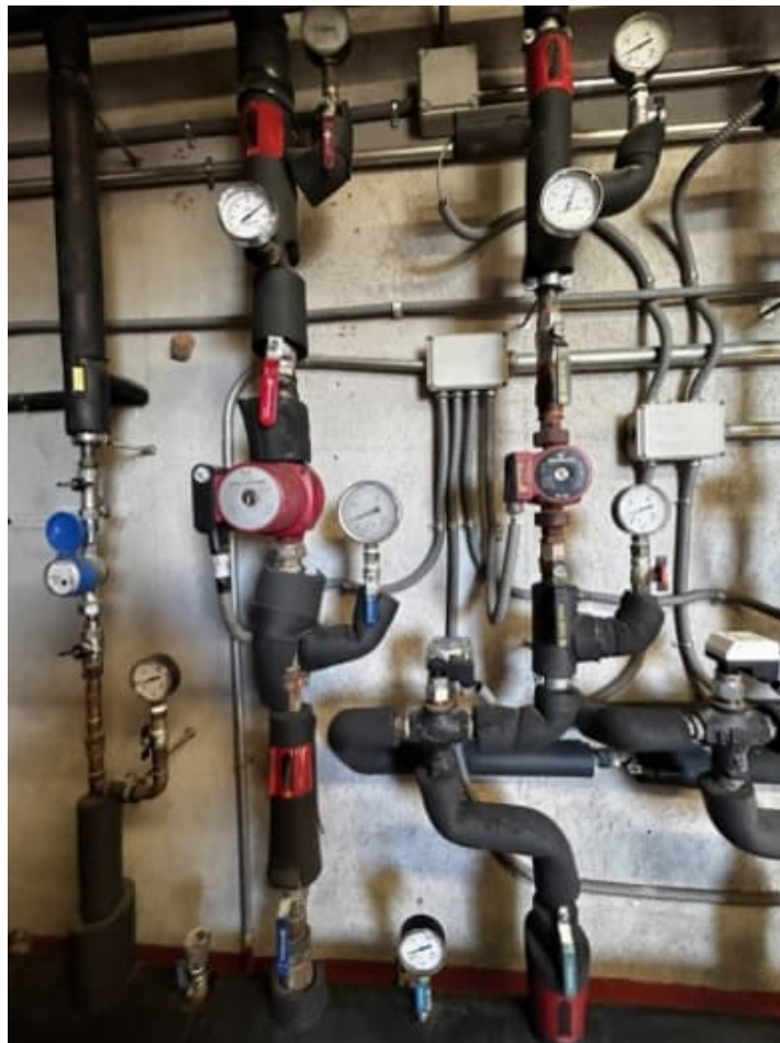
Foto 10. Estat sistema de calefacció existent
