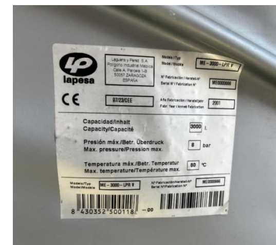
Foto 5. Acumular ACS solar existent en sala tècnica de PC
