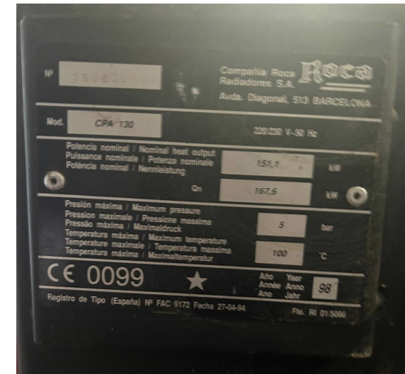
Foto 8. Caldera d'ACS+Calefacció existent actualment en el pavelló
