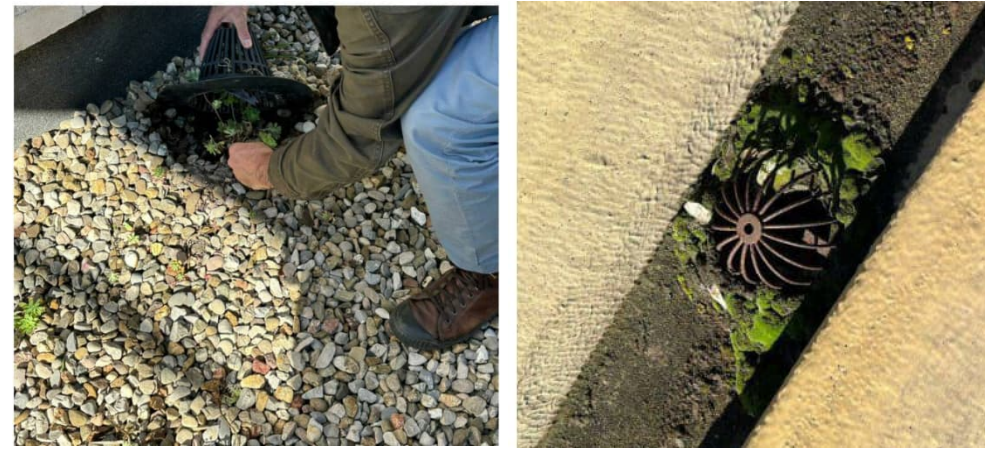
Figura 2: P3.8 Embornal malament col·locat, Figura 1: Creixement de molsa en coberta i provoca enfonsament de graves col·lapsant el sistema d'evacuació d'aigües pluvials. Figura 1: Creixement de molsa en coberta i provoca enfonsament de graves col·lapsant el sistema d'evacuació d'aigües pluvials.
