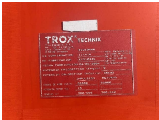
Foto 1: Característiques nominals UTA existent
