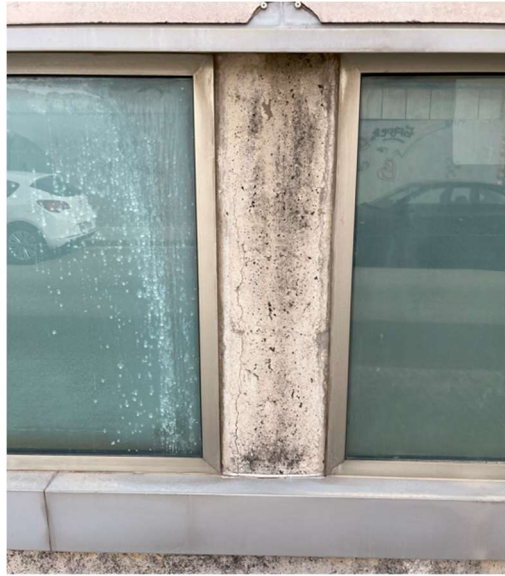
F1- Pilastra carrer Sant Bonaventura (grau 1)
