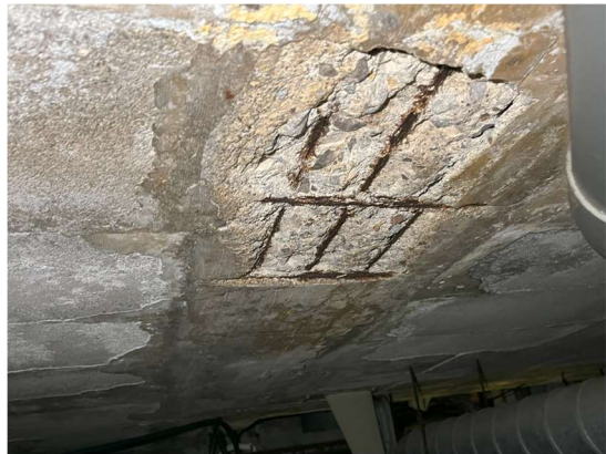
F33 – Òxid armadura en vestuari grups 4 (grau 2)
