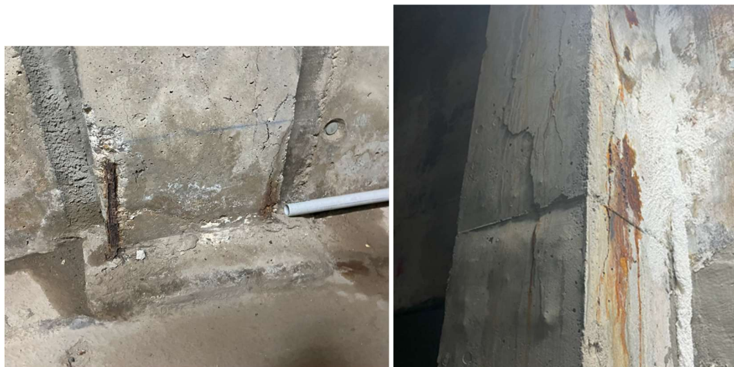
F23 | F24- Estructura en zona dipòsits compensació i maquinària piscina (grau 2)
