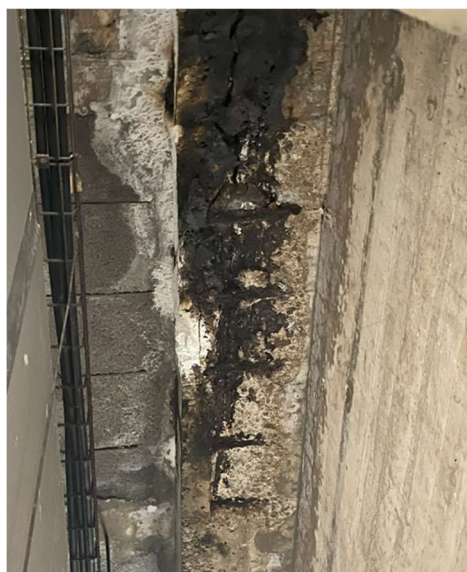
F41 - Estructura en zona dipòsits compensació i maquinària piscina (grau 3)
