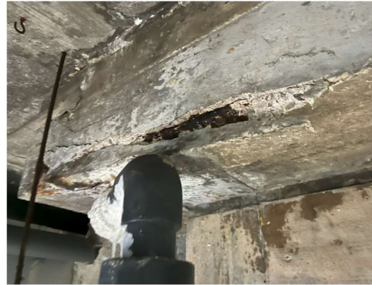
F32 – Òxid armadura en office (grau 2)
