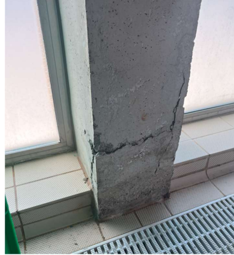
F38 – Base pilar zona piscina (grau 3)
