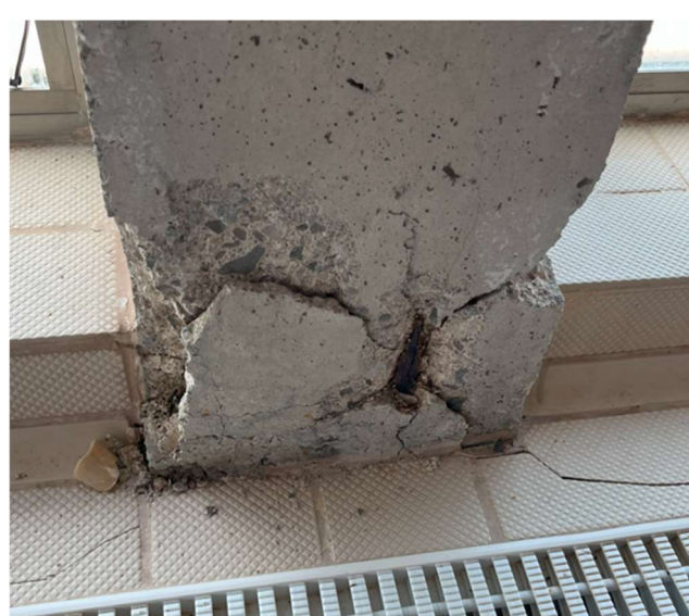
F36 – Base pilar zona piscina (grau 3)
