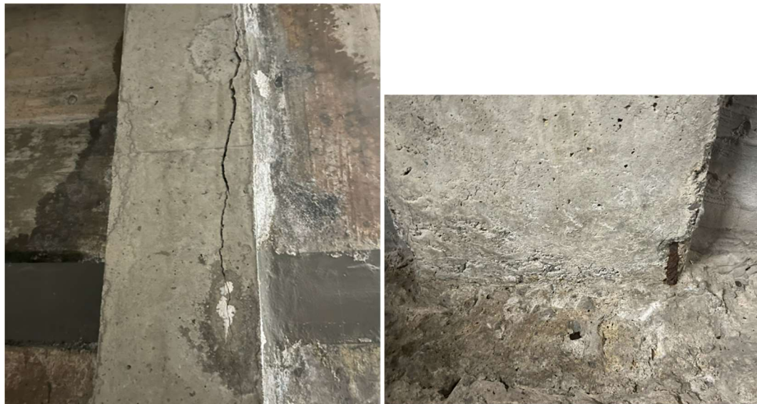
F21 | F22- Estructura en zona dipòsits compensació i maquinària piscina (grau 2)
