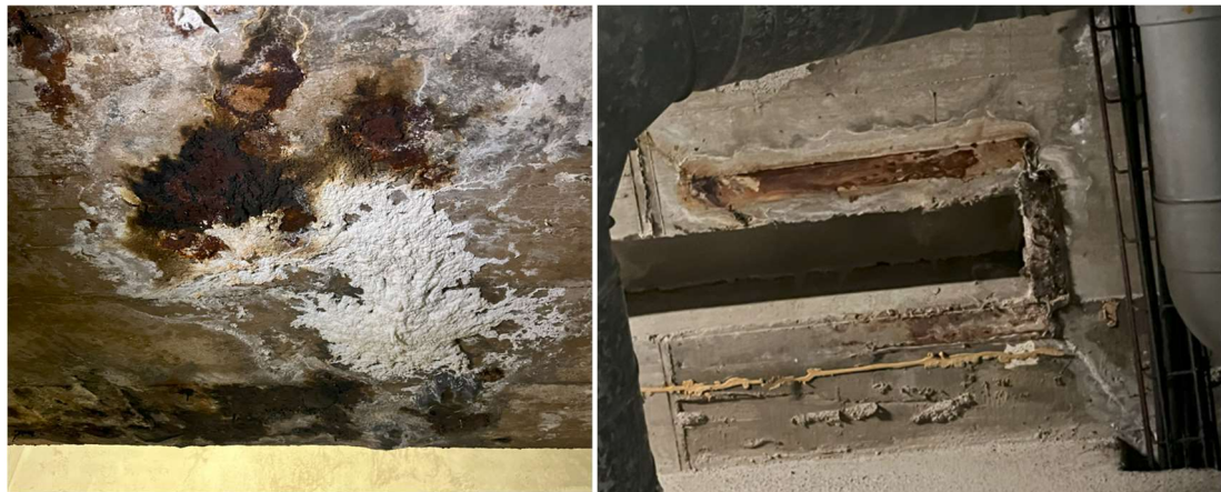
F17 | F18- Estructura en zona dipòsits compensació i maquinaria piscina (grau 2)
