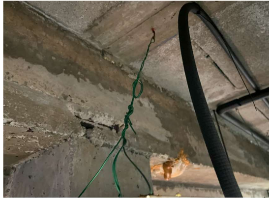
F31 – Òxid armadura en office (grau 2)
