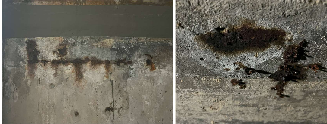
F19 | F20- Estructura en zona dipòsits compensació i maquinària piscina (grau 2)
