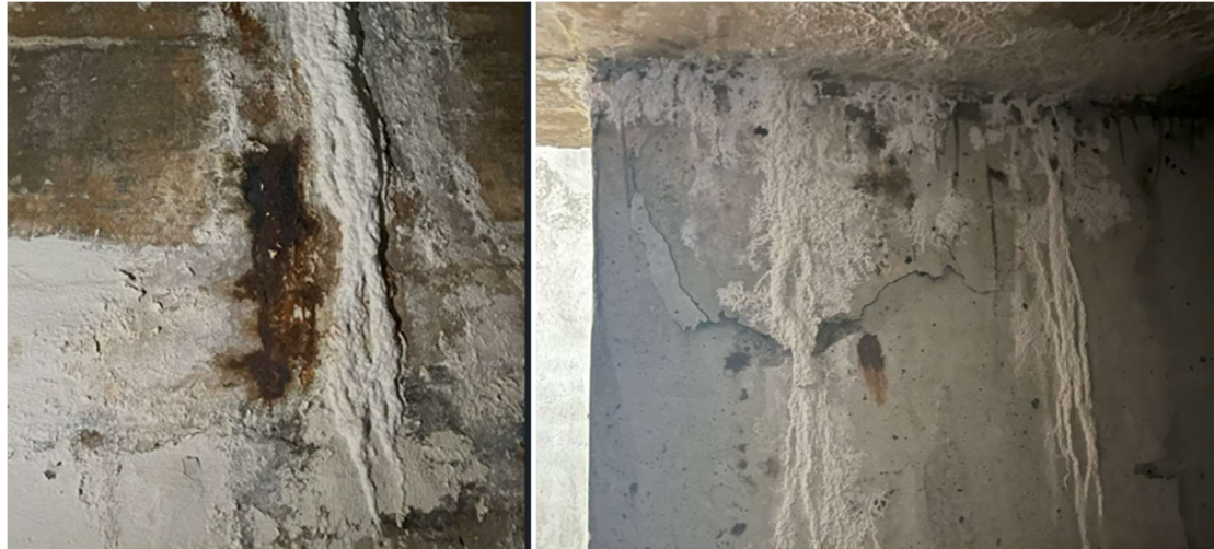
F15 | F16- Estructura en zona dipòsits compensació i maquinaria piscina (grau 2)
