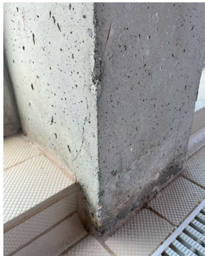
F39 – Base pilar zona piscina (grau 1)
