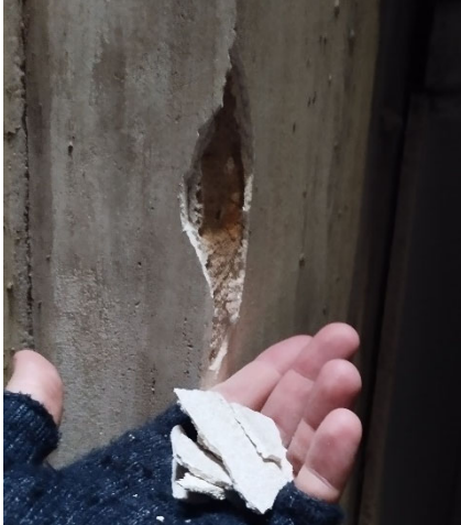
1. Mosteig al revestiment general del pati de la finca.
