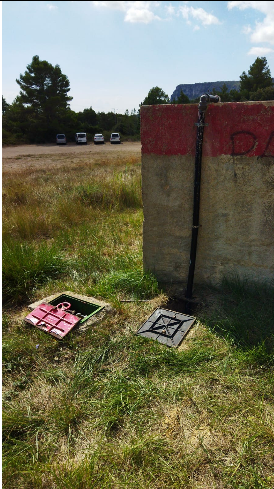
01.02.4 ACTUACIÓ 4 (COMPTADOR A BASSA BOMBERS)
