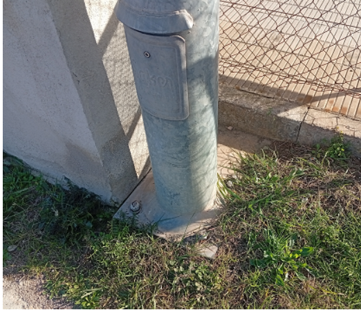
Imatge 7. Columnes d'enllumenat a retirar.
