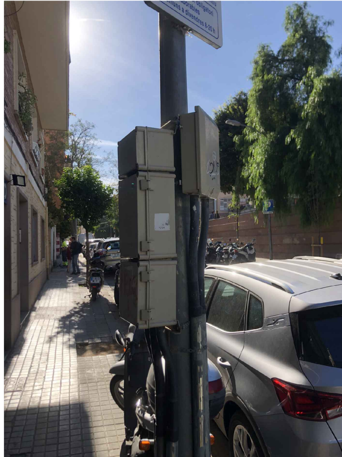
F13 - Instal·lació elèctrica a fanal
