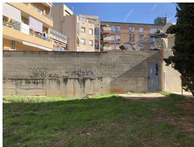
F6 - Límit nord-est de l'àmbit amb mur de bloc i sortida d'emergència
