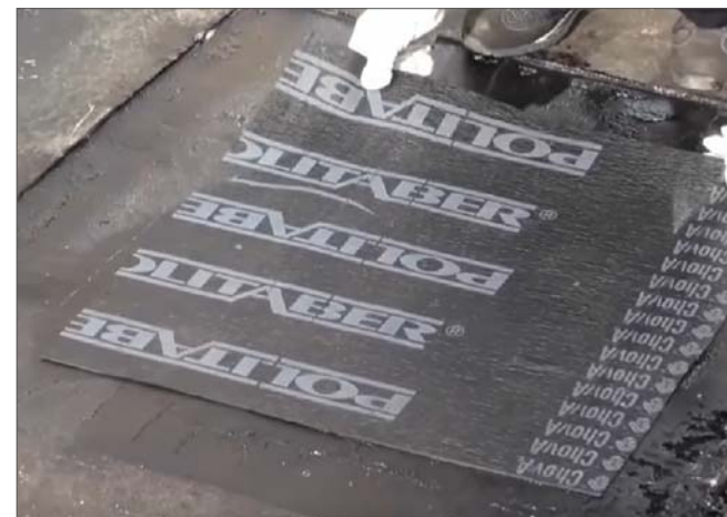
3 - Es retallarà la làmina impermeable 15cm menys que l'àmbit sanejat i es realitzarà el soldat en calent de la làmina impermeable a la superfície sanejada.
