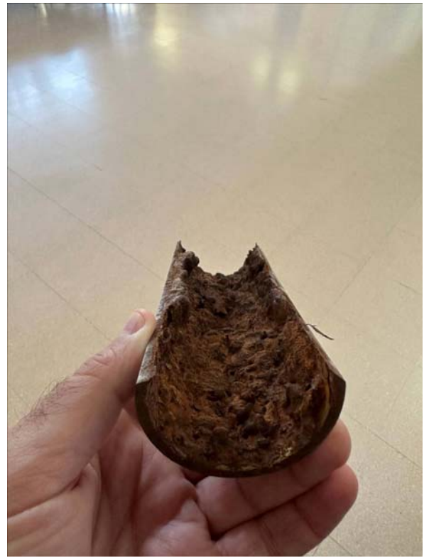
Imatge de l'estat actual que es troben les canonades
