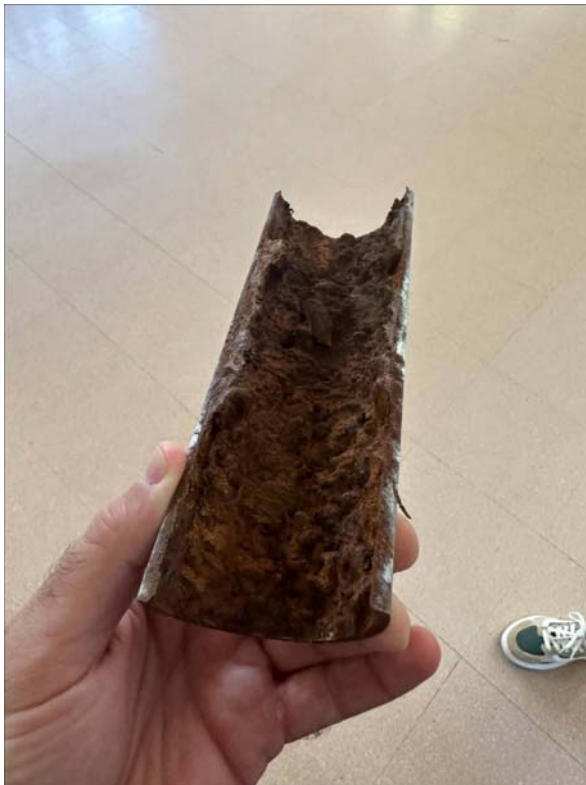
Imatge de l'estat actual que es troben les canonades
