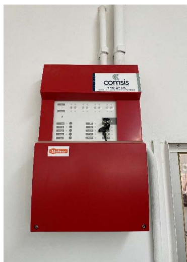
Central d'incendis existent
