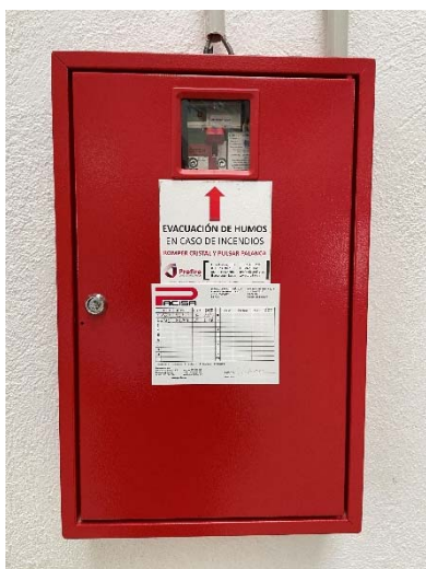
Quadre evacuació de fums existent
