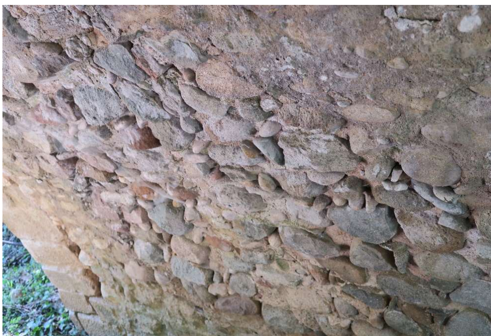
Detall de la maçoneria de la volta al punt on el morter està més degradat
