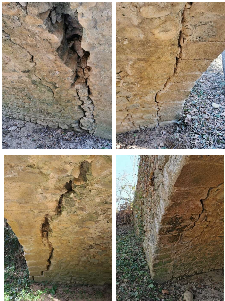
Detall de les esquerdes de la volta. Es troben als punts d'unió entre els murs exteriors i la volta central.
