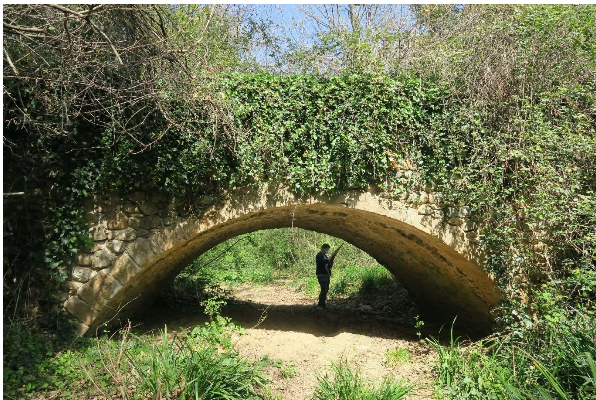
Estat del pont el Març de 2021.
