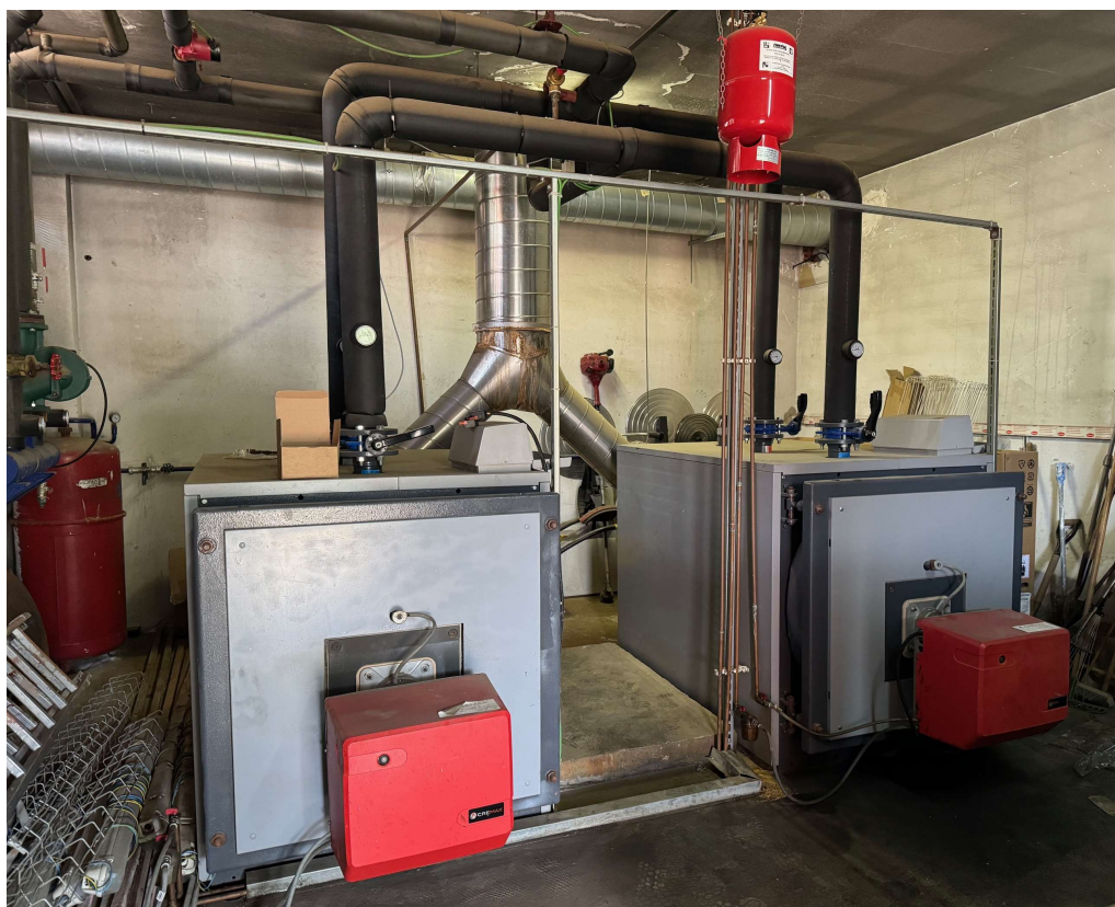
Calderes existents en sala calderes. Planta Baixa.
