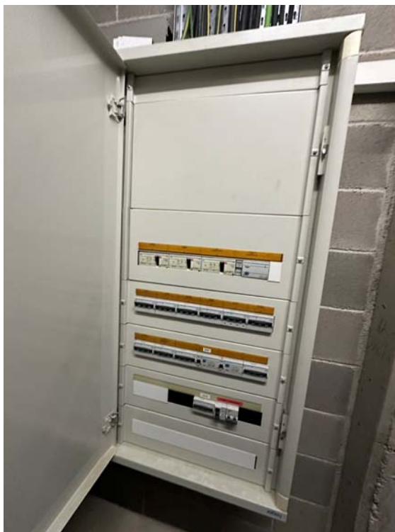
Subquadre situat a l'edifici existent
