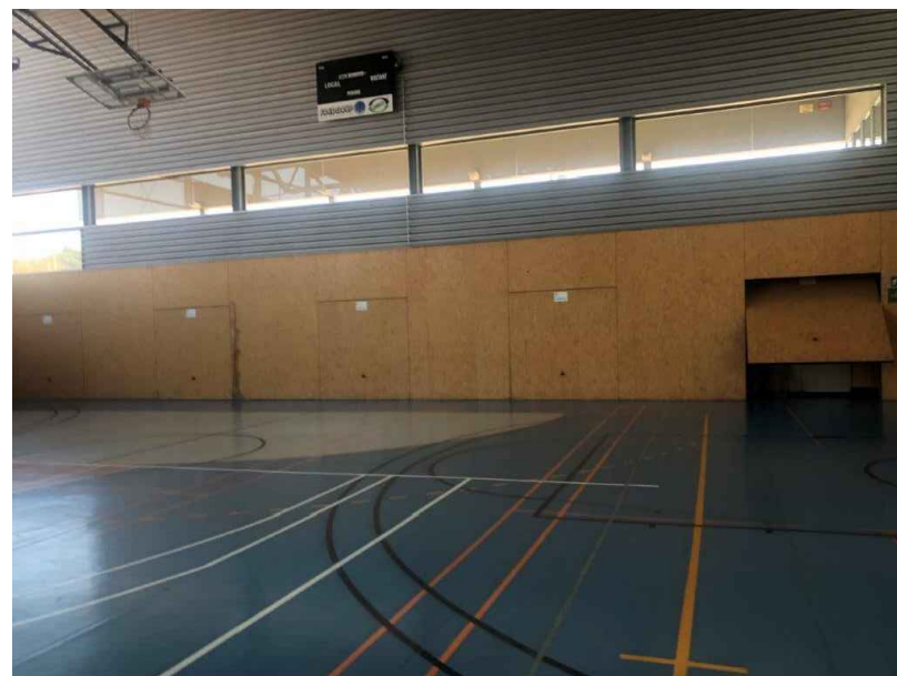
F08. Portes d'accés a magatzem de material esportiu
