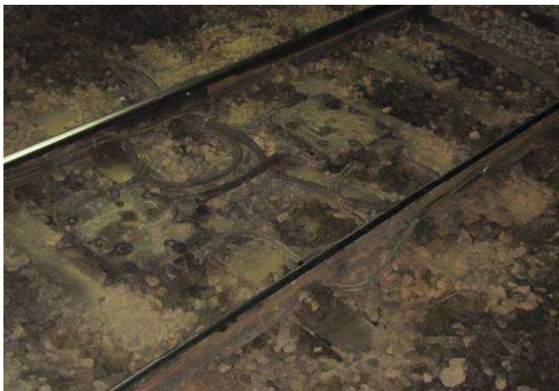
Figura 3.2 Exemple de mala ubicació de cablejat a entrevia
