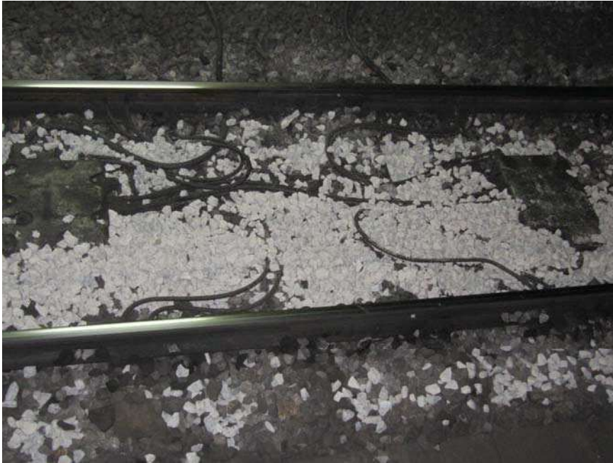
Figura 3.1 Exemple de mala ubicació de cablejat a entrevia
