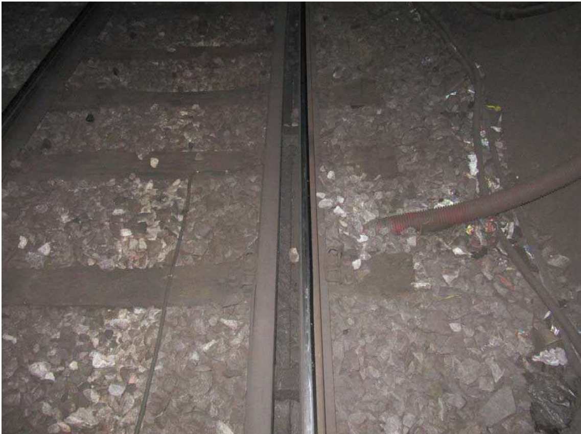
Figura 3.3 Exemple de cablejat no respectant la distància de 30cm sota travessa
