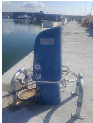
Fotos 1. Exemple de torretade prova telegestionada instal·lada
