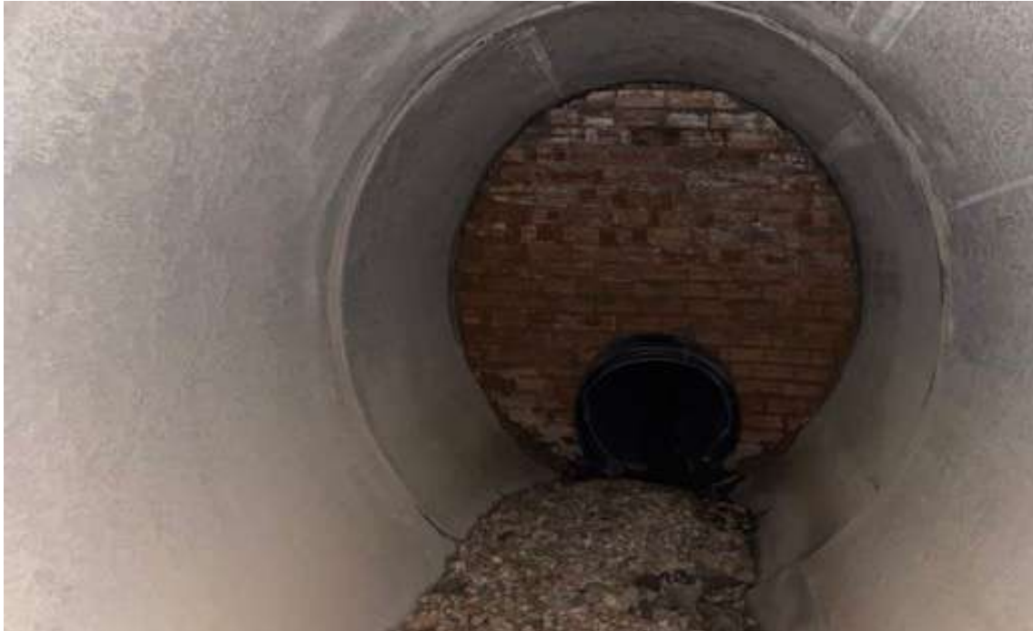
Imatge 3. Vista de la trobada entre el col·lector de pluvials antic (PP DN1000) i el nou (formigó DN2500). El nou està correctament dimensionat. S'observa el material sòlid arrossegat per la DANA i que es va dipositar en el fons.
