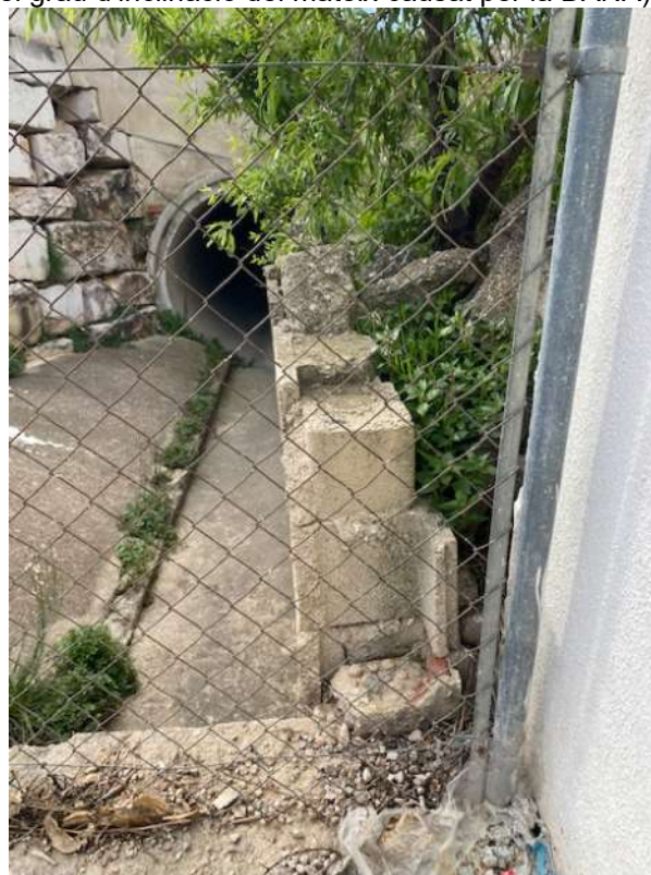
Imatge 2. Vista del grau d'inclinació del mur de contenció degut a l'empenyiment de les terres ocasionat pels efectes de les pluges de la DANA i on es pot veure la seva fallada i col·lapse (que serà imminent). Per a apreciar la inclinació es pot agafar de referència el mur de bloc d'habitatges.
