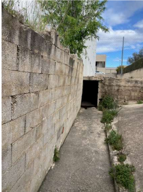
Imatge 1. Vista del mur de contenció que realitza la transició del col·lector de pluvials rectangular al circular (es pot percebre el grau d'inclinació del mateix causat per la DANA).
