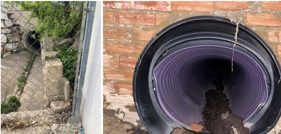
Imatge 7. Afeccions del temporal a la infraestructura hidràulica.
