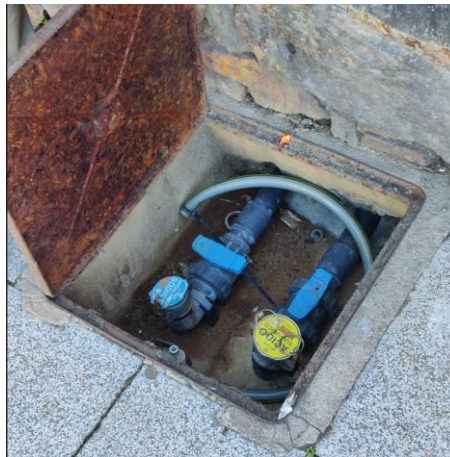
Pericó d'omplerta d'àcid sulfúric i hipoclorit sòdic de la sala de bombes inferior
