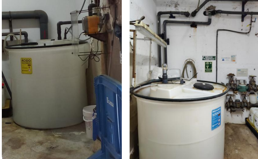
Dipòsits d'àcid sulfúric i hipoclorit sòdic
