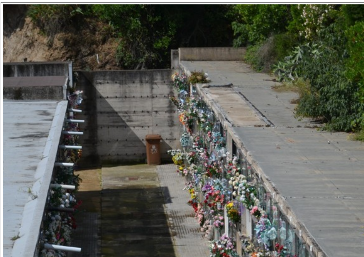
Coberta amb tela asfàltica i gàrgoles improvisades de PVC
