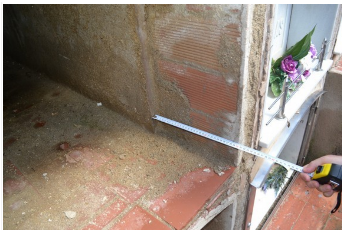
Deteriorament del revestiment del nínxol degut a la humitat
