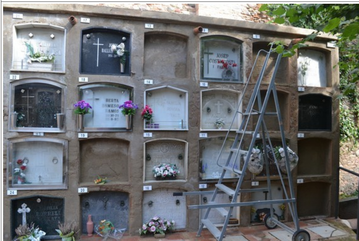
Desprement, fissures i gàrgoles ceràmiques cilíndriques
