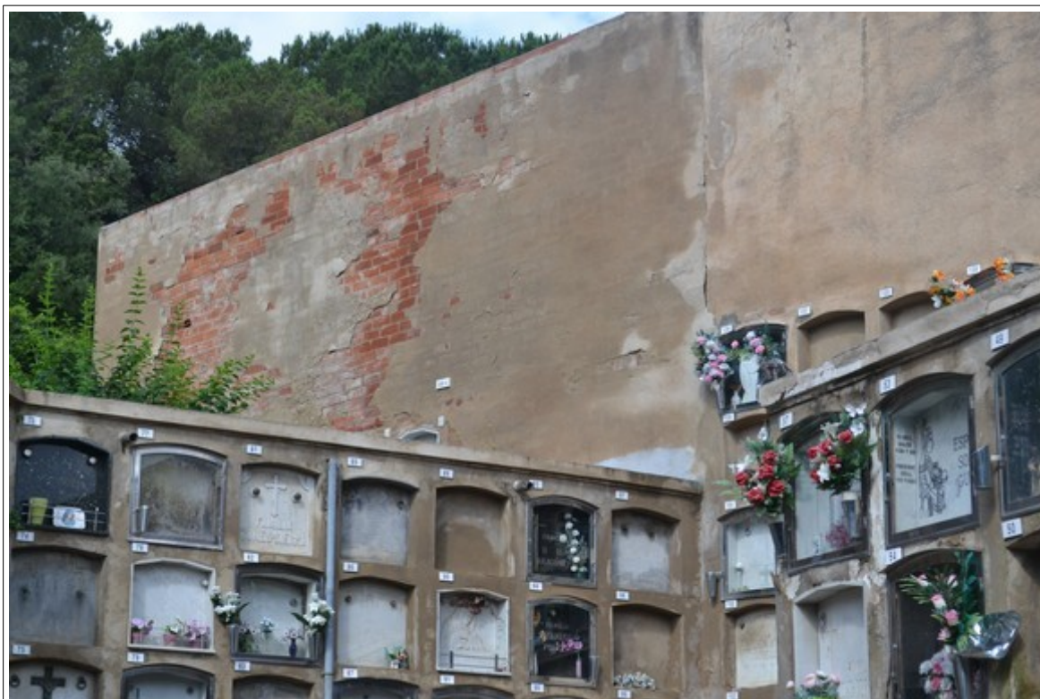
Despreniments i humitat a la part posterior dels nínxols
