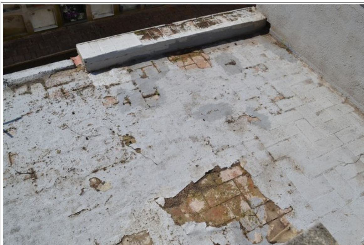
Pintura deteriorada i rajoles amb verdet
