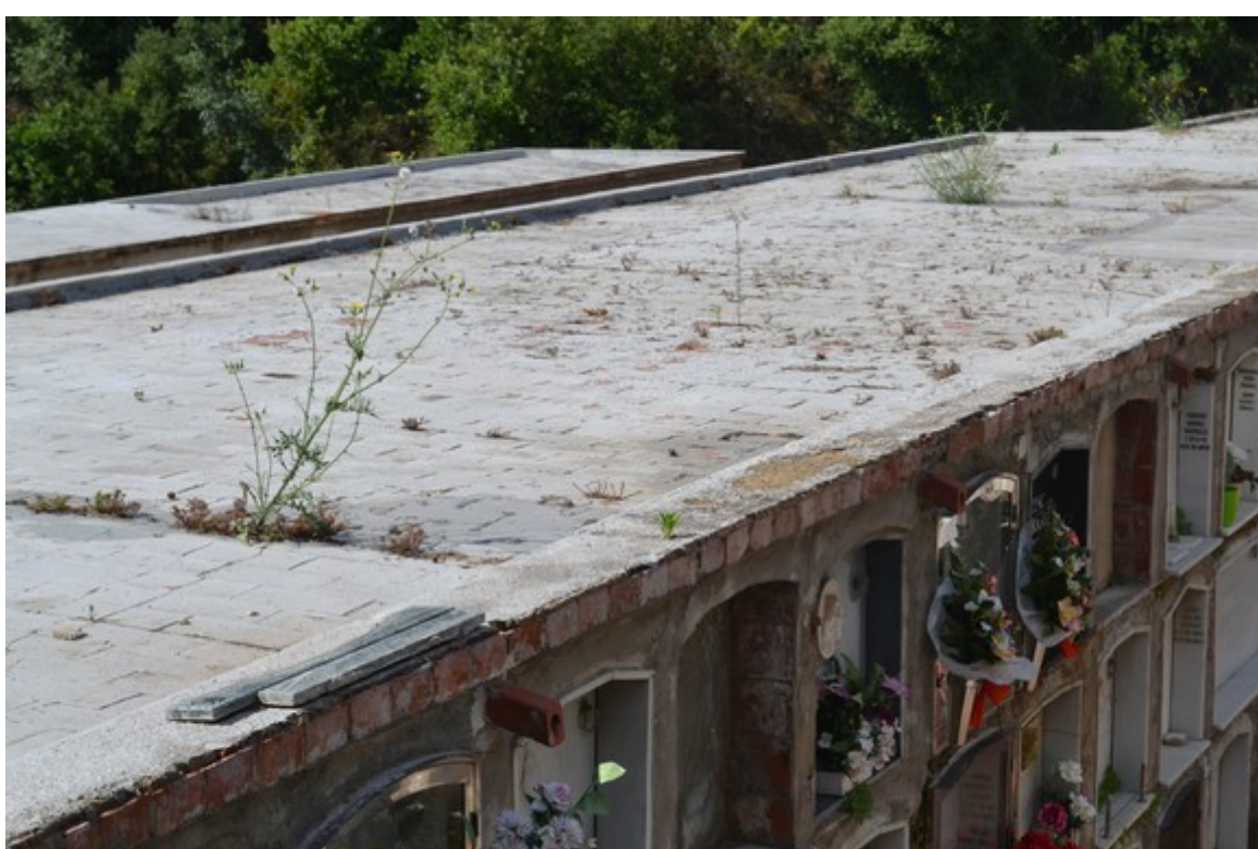
Vista general on s'aprecia la vegetació que creix, els punts on s'acumula l'aigua i diferents tipus de gargoles. I pintura impermeabilitzant deteriorada
