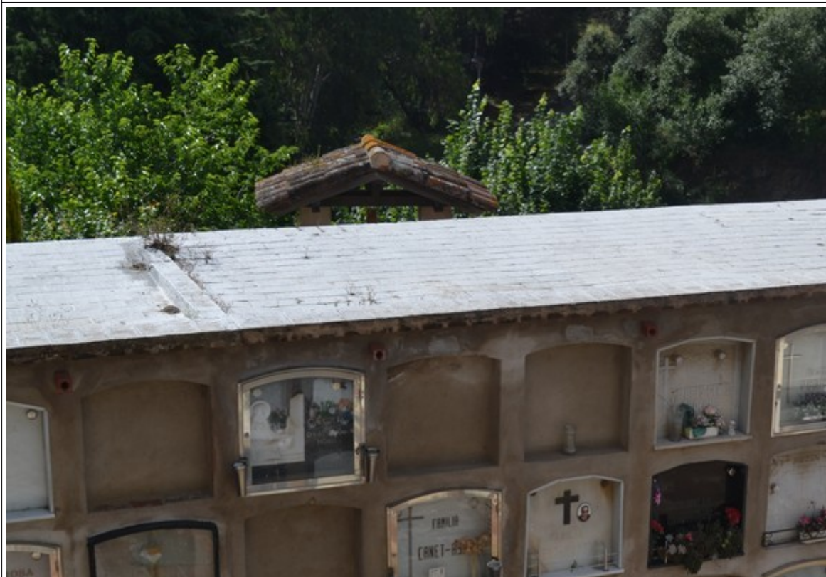
Restes d'acumulació puntual d'aigua on s'acumula terra i creix la vegetació
