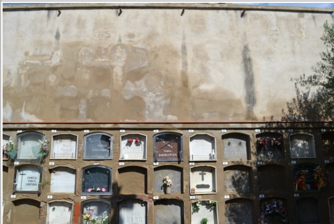
Despreiments, humitats, eflorescències i gàrgoles ceràmiques cilíndriques
