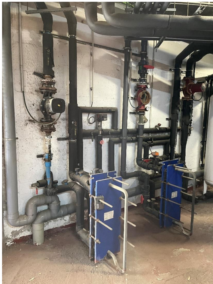
Fotografia 2: Circuits instal·lació solar tèrmica existent.
