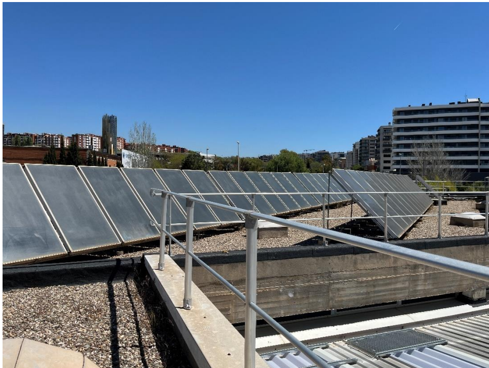
Fotografia 6: Instal·lació solar tèrmica existent.
