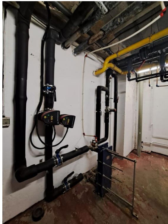
Fotografia 4: Bescanviador de calor ACS amb caldera.
