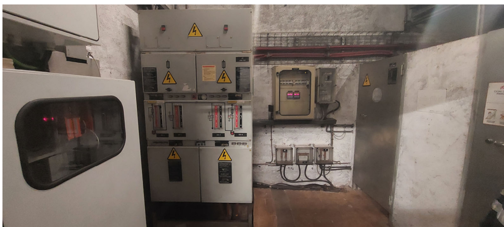
Vista general CT L2 estació Artigues|St. Adrià
