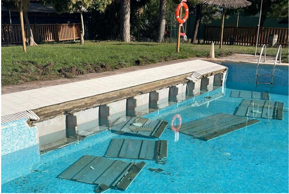
Imatge 9 Mur en zona desbordant de piscina N° 1
