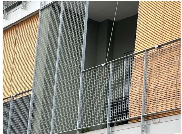
Vista de la terrassa de l'habitatge (ubicació de la màquina exterior), baixant de connexió de desaigües (un cada dos terrasses)
