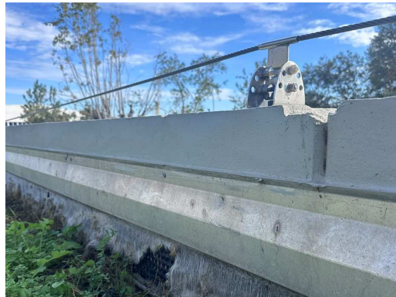
11 Linia de vida perimetral.
