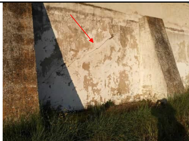
Fotografía nº 21 Empujes en el muro.
