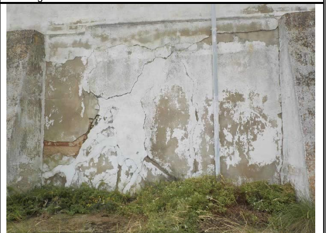
Fotografía nº 17 Patologías visibles en la fachada norte del cementerio.
