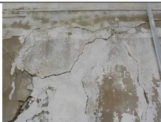
Fotografía nº 19 Otro detalle de la imagen nº 17, de las patologías en la fachada norte.
