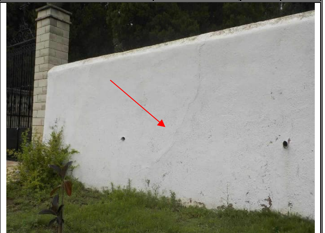
Fotografía nº 15 Patologías visibles en la fachada este del cementerio.
