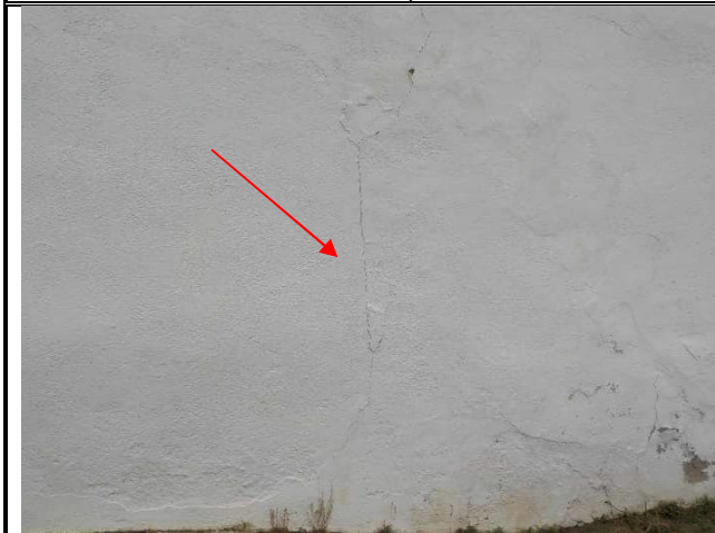
Fotografía nº 14 Patologías visibles en la fachada sur del cementerio.
