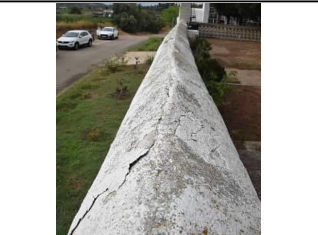
Fotografía nº 25 Detalle de la deformación de la cabeza del muro de acceso (zona este).
