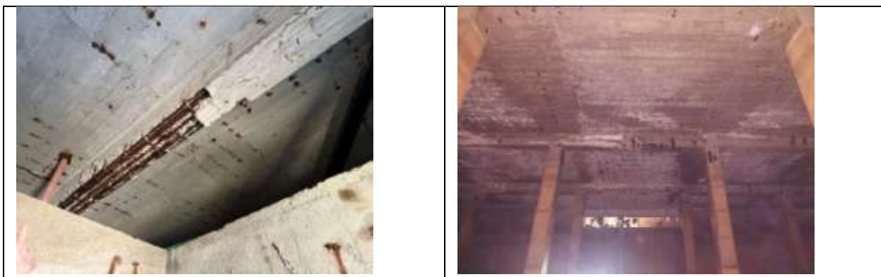
Imatge 4. Estat actual dipòsit Cullets
