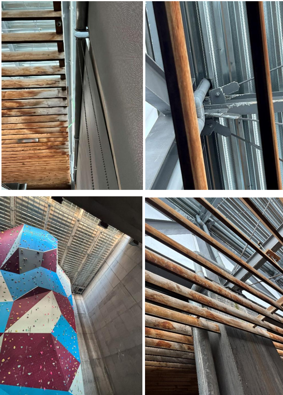
Imatges eflorescències i decoloracions dels elements malmesos per les filtracions
