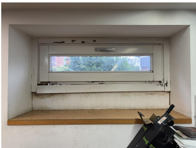
Imatges 250723-10. Exemple de podriments d'elements de fusta d'escopidors d'una finestra del semisoterrani a la façana principal, que provoca filtracions d'aigua de pluja i degradació dels acabats interiors.
