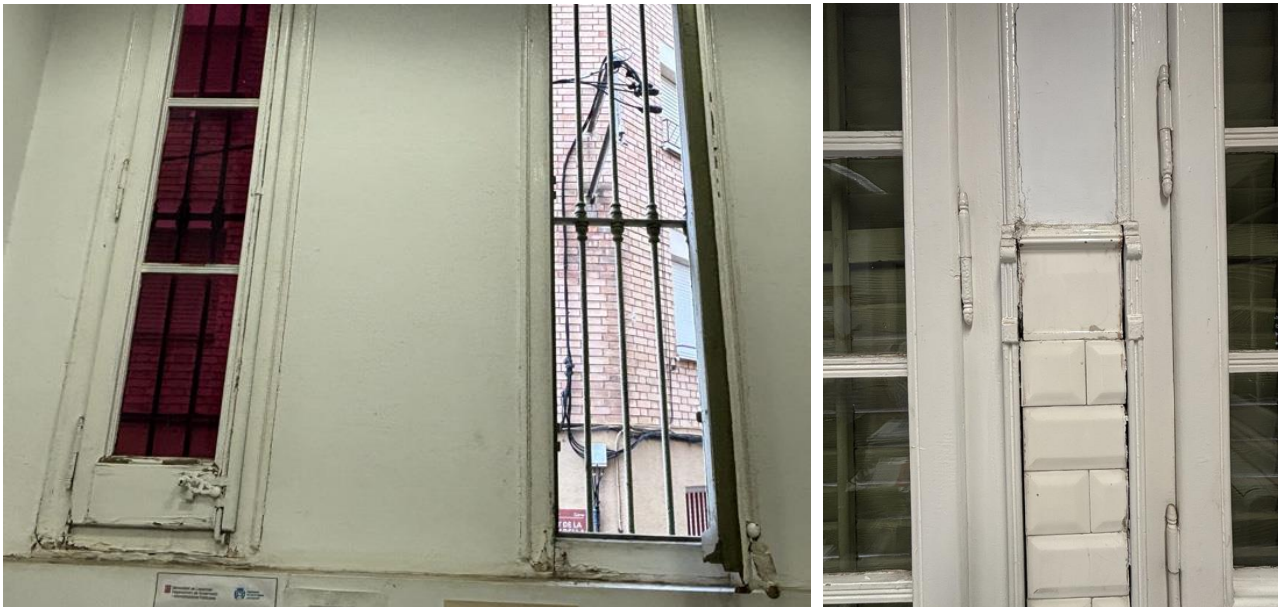
Imatges 250723-15 i 25. Aspecte de trams de segellats entre fusteries i revestiments d'acabat interiors a finestres de planta baixa i primera.
