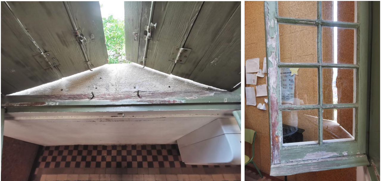
Imatges 250730-101617 i 101604. Exemples de despreniments de pintura d'acabat de fusteries a la façana principal.
