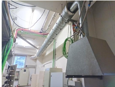
Actual sistema no operatiu per ineficient basta en impulsió d'aire de l'exterior cap al interior de la sala sense extracció del aire calent generat.
