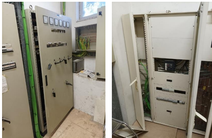
Actuals mòduls dels quadres de comandament i protecció de servei normal i d'emergència a retirar
