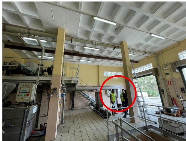
Figura 9. Armaris elèctrics existents per a maniobra de la centrífuga i la seva situació
