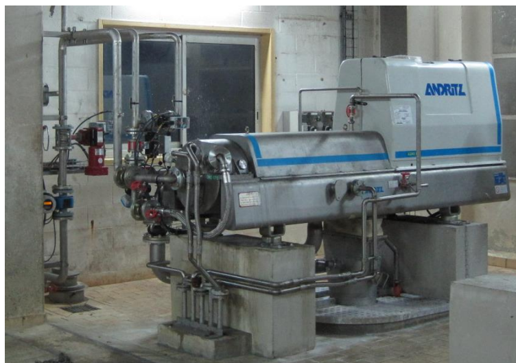
Figura 15. Conexiones tuberías de agua de lavado.
