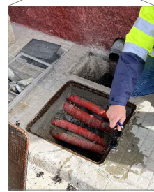
En aquesta arqueta s'observa com els tubs del cablejat creuen amb un tub de sanejament
