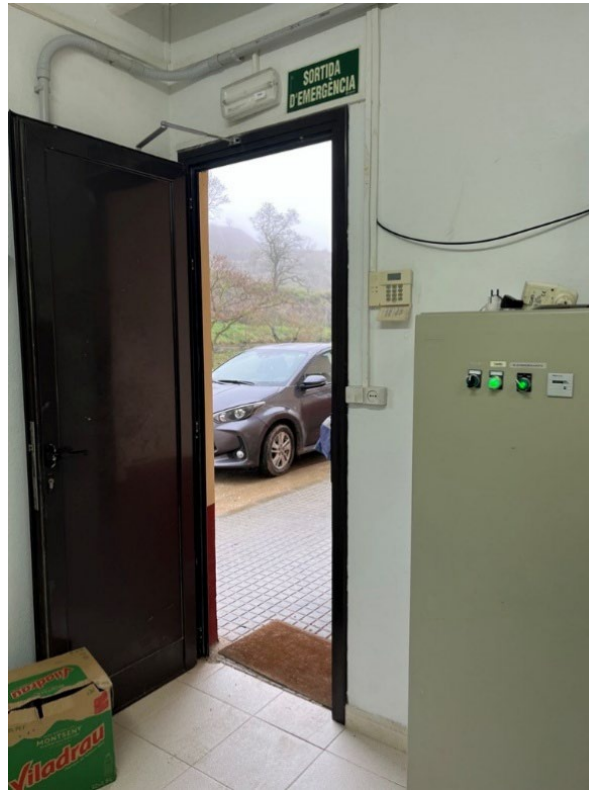
Figura 13. Porta existent d'accés a l'oficina de control
