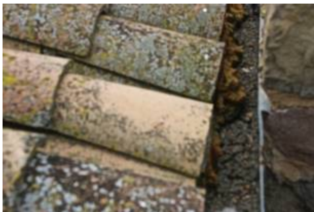
Detall de l'acumulació de dipòsits al canal que recull l'aigua a l'extrem esquerre de la façana oest del castell.
