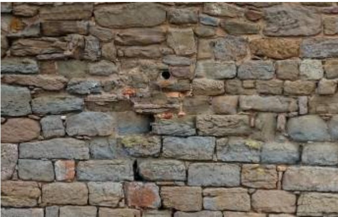
Detall del parament occidental de la torre major amb l'actual punt de sortida de l'aigua acumulada a la terrassa
