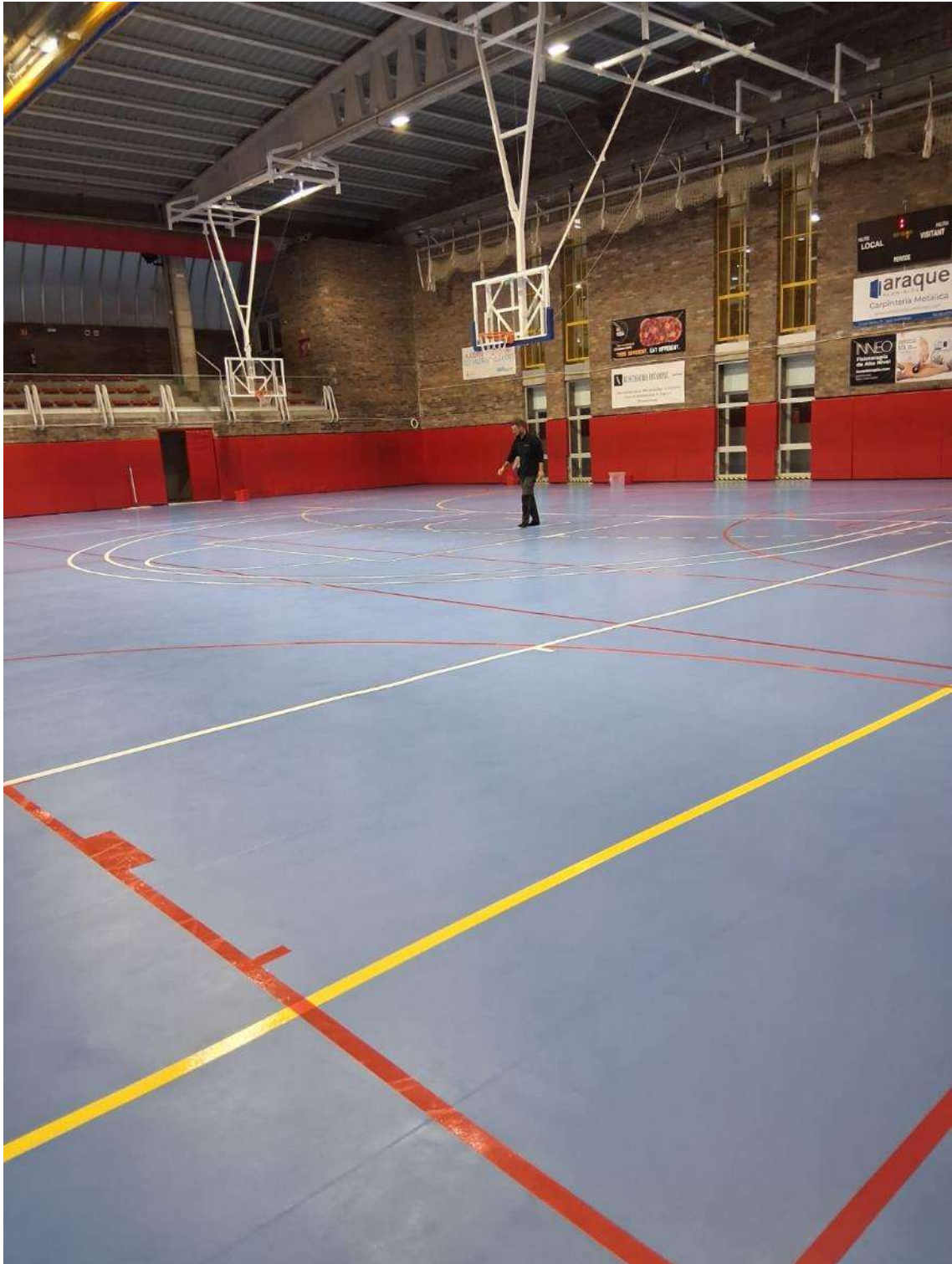
Paviment vinílic actual pista
