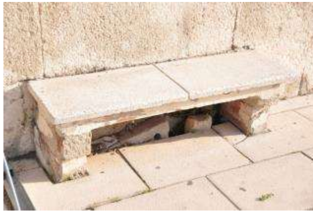
Il·lustració 3 Ventilació del forjat sanitari obturada amb troços i brossa.
