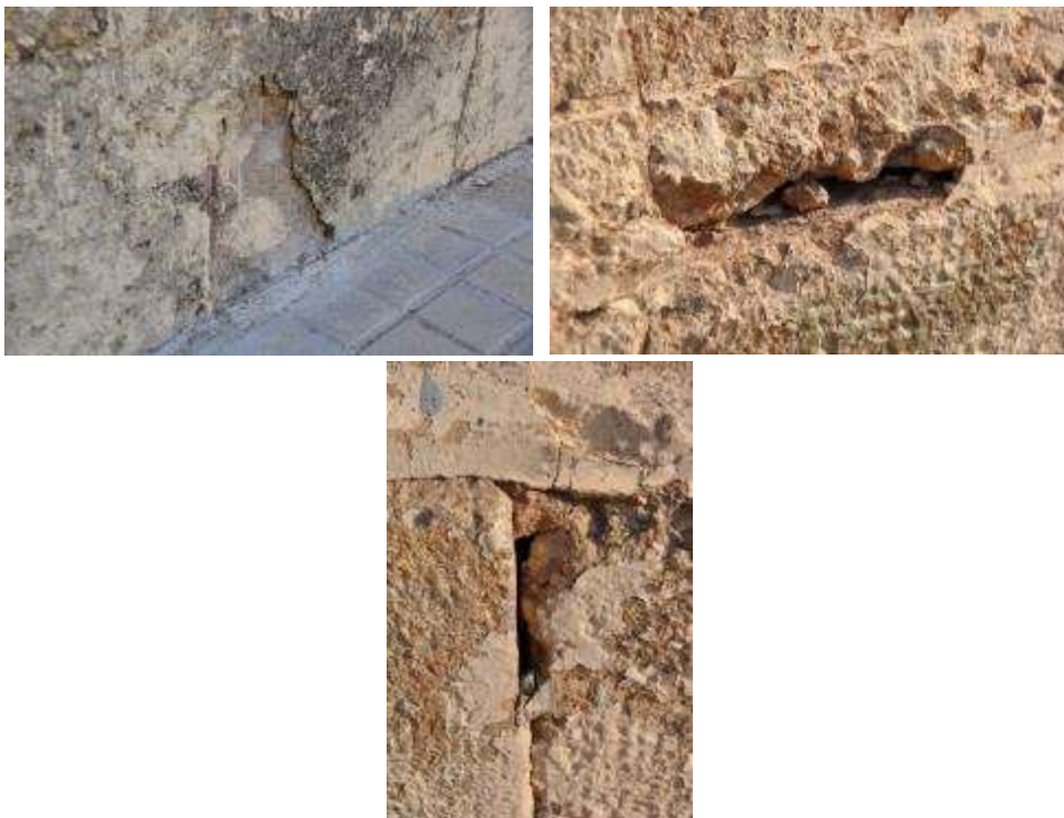
Il·lustració 2 Punts amb degradació evident del sòcol de pedra artificial perimetral.
