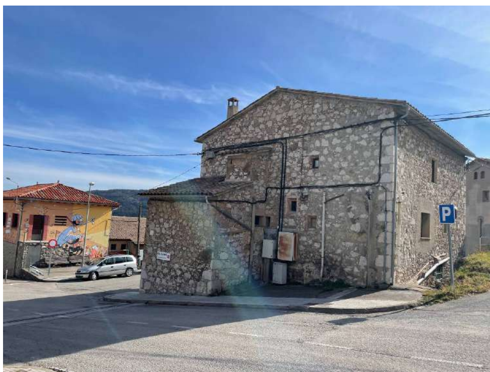
Fotografia 4 – Façana nord o NE des de la carretera de la Mina. Aquesta façana posterior de l'immoble és la més visible (carretera de la Mina) i la més castigada per les instal·lacions (BT, enllumenat, evaüació d'aigües i telefonia). Es projecta una placeta o terrassa pública al reclau format pels dos cossos a nivell de P1 per l'accés als habitatges. Es construirà uns armaris per als quadres elèctrics. En una futura fase dos es preveu retirar els baixants de P2 emprant les previsions interiors que s'executaran en aquesta fase.
