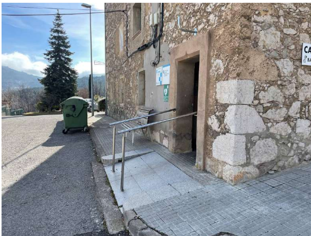
Fotografia 5 – Accés “adaptat” al centre mèdic. Les baranes s’hi van instal·lar per facilitar la pujada de la rampa amb el pendent desfavorable del carrer. Això impedeix la circulació per la vorera obligant a vianants a transitar per la calçada. Amb la recuperació de l’accés a façana principal, aquest problema queda resolt. Es preveu deixar aquesta porta com a sortida d’emergència des del futur magatzem del CAP (actual vestíbul).
