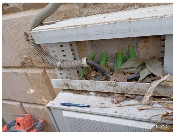
Imatge 3 cable escomesa a substituir
