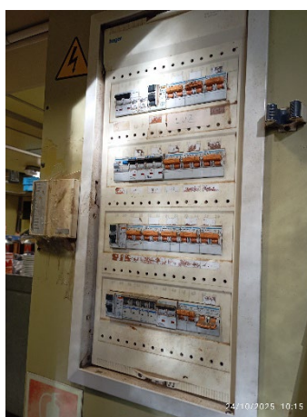
Imatge 5 Quadre elèctric guingueta
