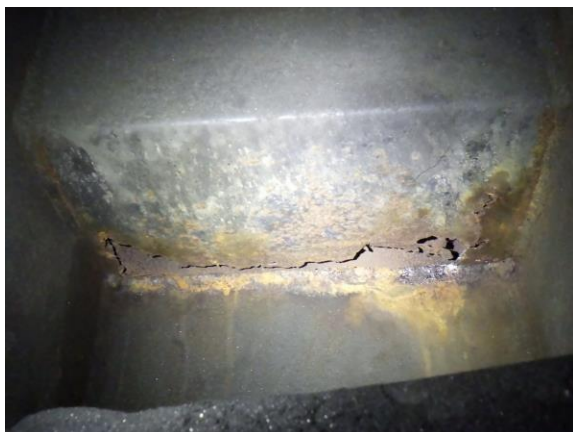
Pos. 02: corrosió molt forta a l'estructura del membre lateral extrem. La xapa metàl·lica mostra grans forats.
