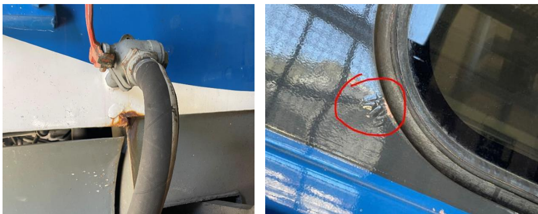
Figura 8: zona corroïda; frontal i bombolla d'òxid a les finestres
