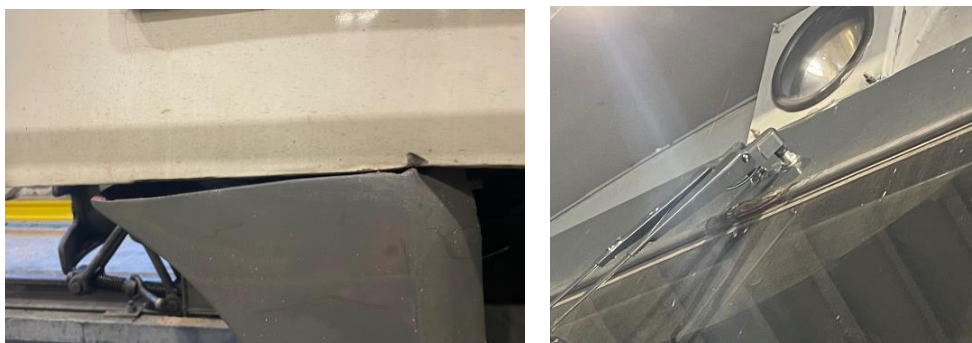
Figura 5: netejador de carril doblegat a l'esquerra/corrosió a la dreta per sota de la rasqueta de la finestra
