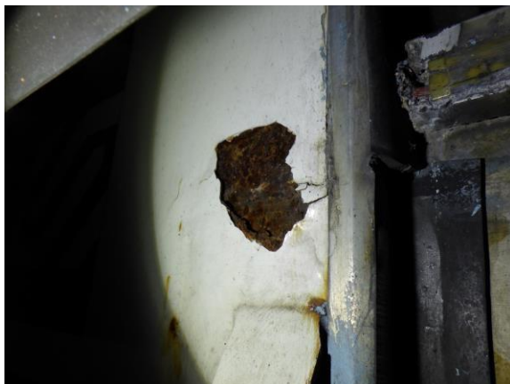
Pos. 13: corrosió sota la pintura al costat de la caixa de pas de l'entrada.
