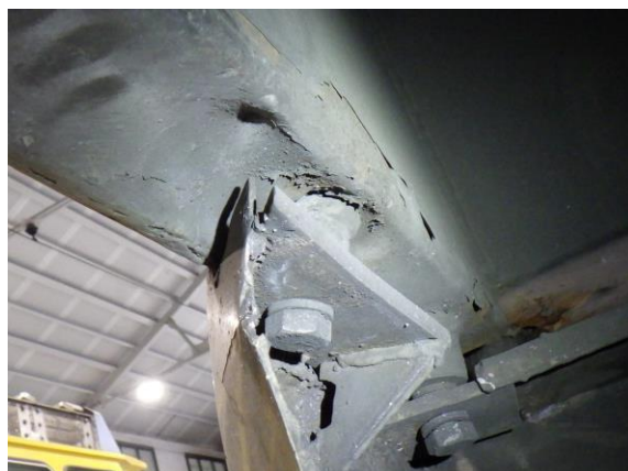
Pos. 05: deformació al suport de muntatge de l'escombradora de via.
