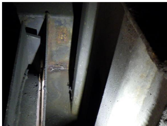
Pos. 03: corrosió forta a l'estructura del membre lateral extrem.
