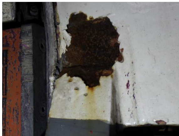
Pos. 14: corrosió sota la pintura al costat de la caixa de pas de l'entrada.
