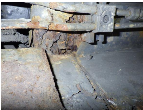
Pos. 08: detall de pos. 07: la placa de pas mostra una forta corrosió. Tot el gruix de la paret de 2 mm s'ha corroït parcialment.
