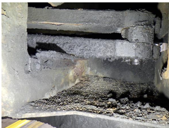
Pos. 01: corrosió a l'estructura del membre lateral extrem. S'ha acumulat molta brutícia en aquesta zona.
