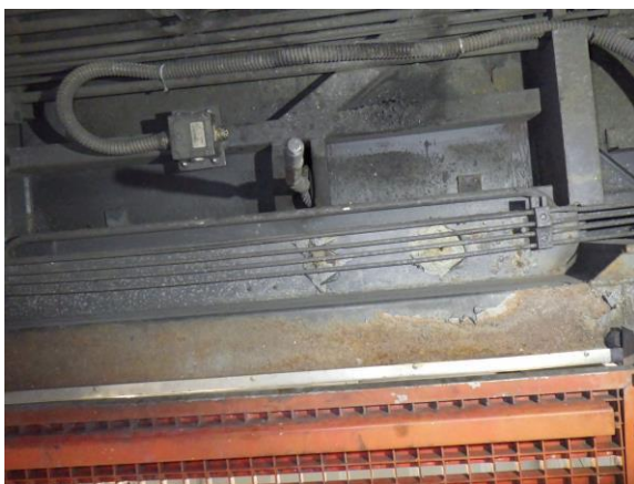
Pos. 09: corrosió sota la caixa de pas.
