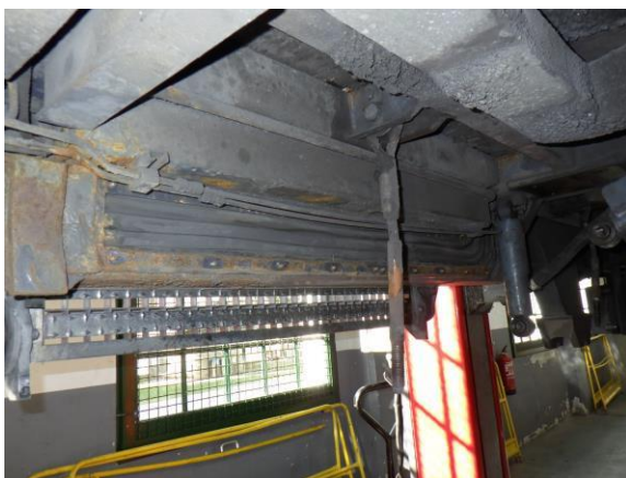
Pos. 07: canal de cable obert. L'obertura no és estanca a la humitat, cosa que permet que la corrosió avanci.
