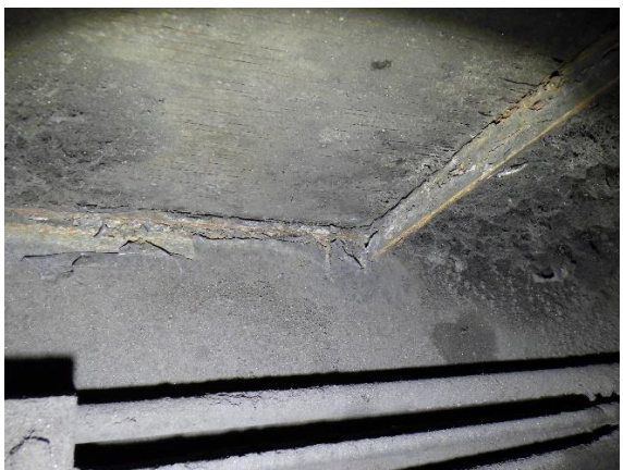
Pos. 11: corrosió a la zona de contacte amb el terra de fusta.
