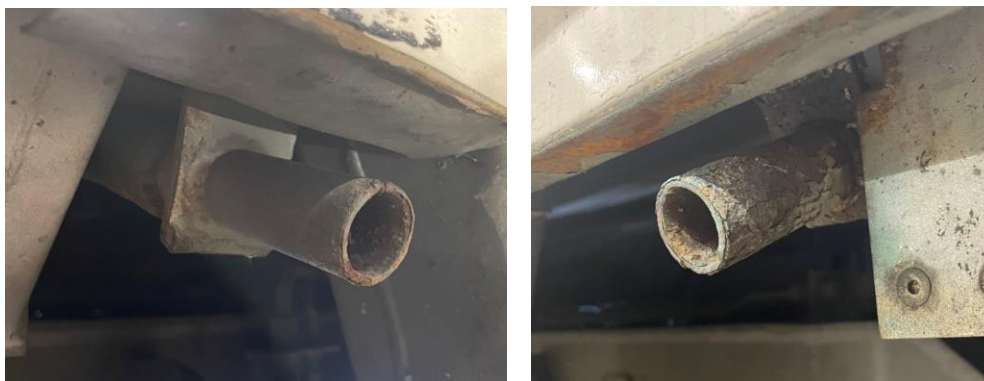
Figura 3: canonada de drenatge corroïda
