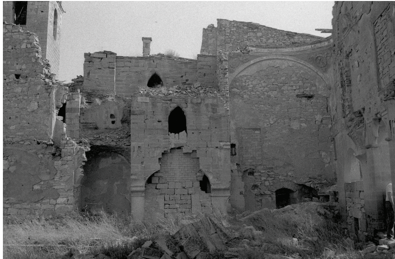
Imatges la zona de contacte entre l'església i el claustre abans de la intervenció de recuperació i restauració del conjunt.
