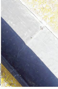
Vista parcial de l'estructura de la coberta del temple amb la capella nord. La malla de plom filtradora.
